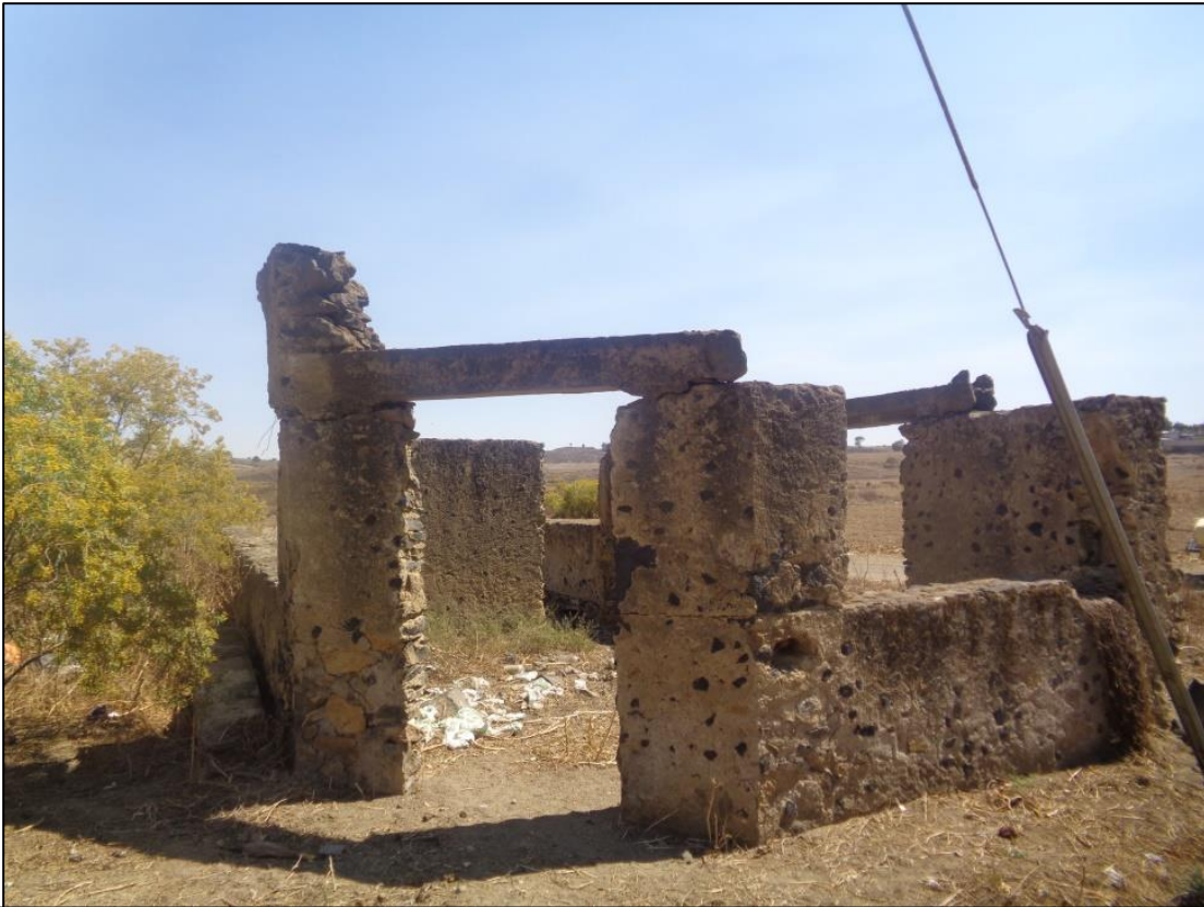
Figura 12. En los vestigios de una vivienda con mamposterías de piedra y trabes de concreto, se puede observar un ejemplo de incompatibilidad entre materiales que fue una de las causas del colapso de viviendas en el sismo de 1973.
