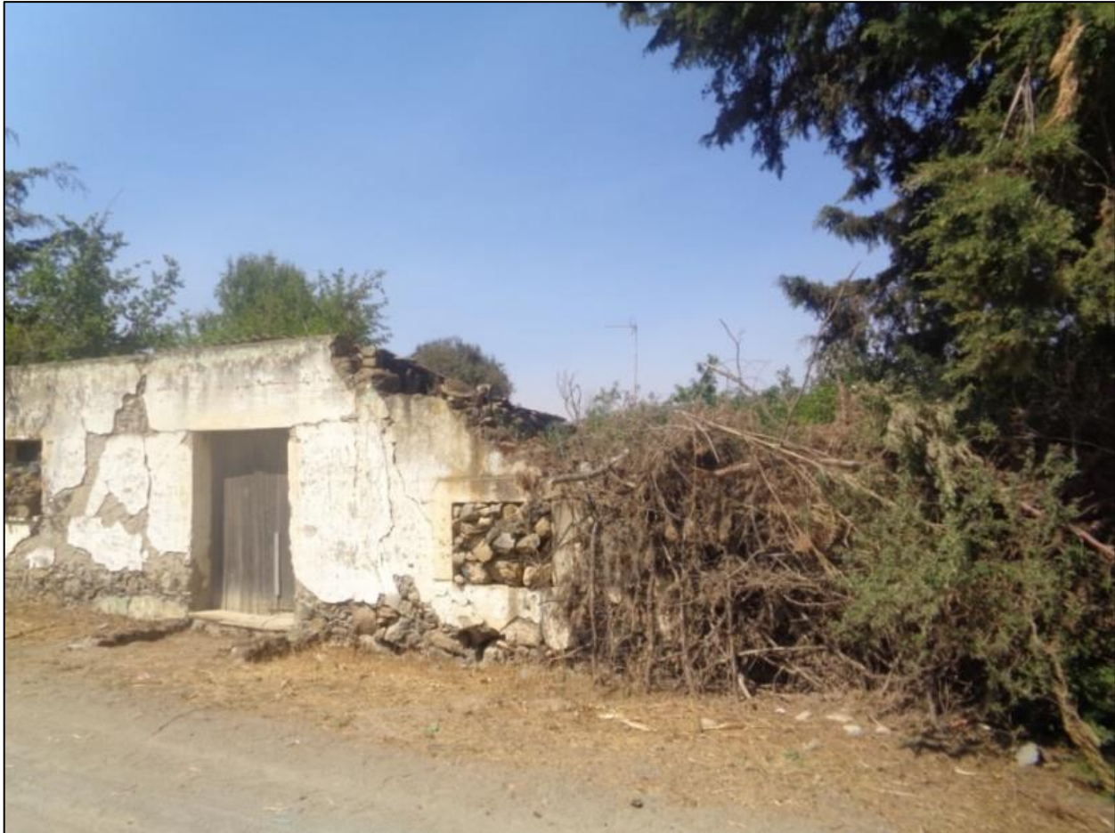
Figura 7. Vivienda vernácula realizada con materiales locales, donde el desinterés de la comunidad por la preservación de su patrimonio construido, ha llevado hacia la desaparición del mismo. (Fuente: Autor, 2019, Lugar: Santa María Techachalco, Municipio de Chalchicomula de Sesma, Puebla)
