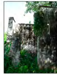
11 DERRUMBE DE MURO EN CALABOZO Y TRONERA.
