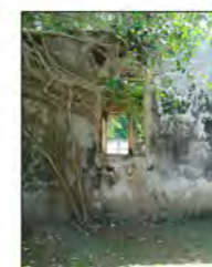
19 DETALLE DERRAME DE VANO EN CRUJIA PRINCIPAL CON FLORA NOCIVA
