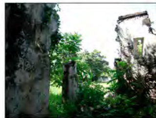
13 INTERIOR CALABOZO. DERRUMBE EN MUROS
