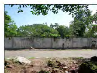
18 DERRUMBE EN MURO DE CRUJIA PRINCIPAL
