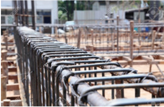
Fig. 16 Refuerzo de acero [I-16]
