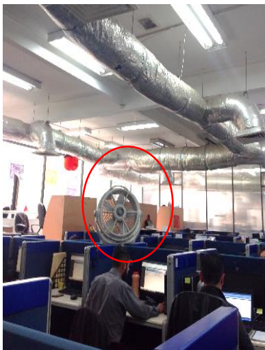
Fig.13 Edad de Aire acondicionado, así como el haber agregado salidas, generó un desempeño ineficiente, obligando a los usuarios a colocar ventiladores de piso.
