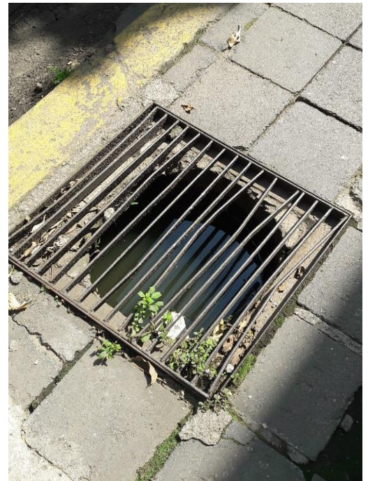
Fig. 16 Se identifica un alto riesgo de inundación (temporada de lluvias). En el sistema de drenaje colindante al Centro de Datos .
