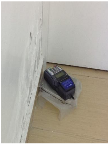
Fig.5 Mal diseño en Centros de pago (deficiencia en planos de mobiliario, conteo de contactos eléctricos de acuerdo con los de equipamiento menor).
