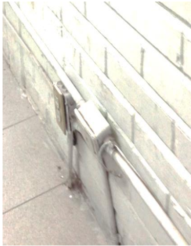
Fig.2 Falta de planeación de instalación eléctrica, falta de elección adecuada de accesorios eléctricos para Centros de trabajo industrial. (CEDIS principal de la empresa).
