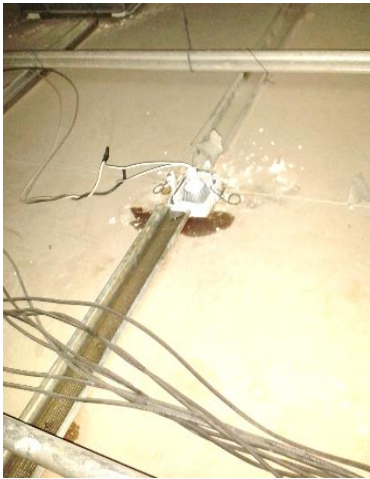
Fig.1 Falta de profesionalismo, supervisión y mantenimiento en las instalaciones ocultas. Falta de registros.
