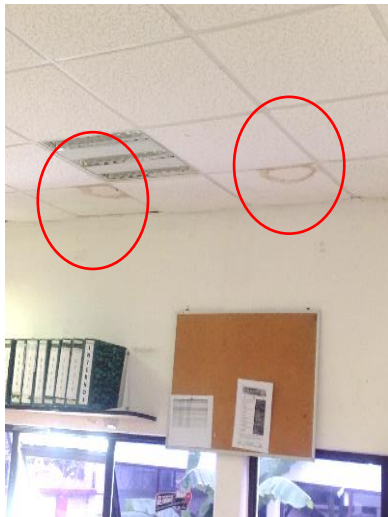
Fig.10 Falta de observación y atención a las patologías evidentes en plafones.
