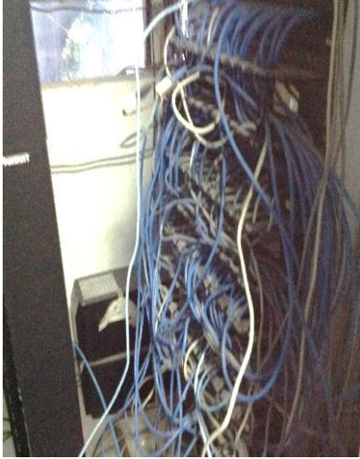
Fig.6 Falta de coordinación de ingenierías al realizar las instalaciones de voz y datos. Actualmente el área de Sistemas realiza con su propio personal o con sus empresas externas los cableados de Voz y datos sin solicitar VoBo al área de infraestructura.
