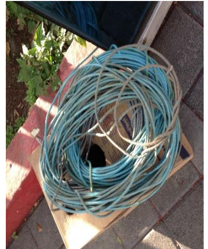
Fig.8 Cableado dañado UTP 5E para interiores colocado a intemperie en cámaras de CCTV exteriores. Se procedió al retiro tras falla de imagen en monitores de CCTV.
