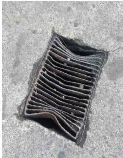
Fig.11 Accesorios en mal estado por rodamiento de trailers que permiten el paso de residuos sólidos, tapando los registros y por consecuencia provocando inundación en patios de maniobras. (CEDIS).
