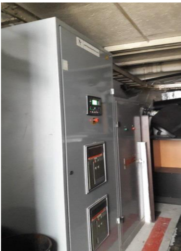
Fig. 15 La subestación, y planta de emergencia no cuentan con cámaras para el monitoreo de actividades al interior.
