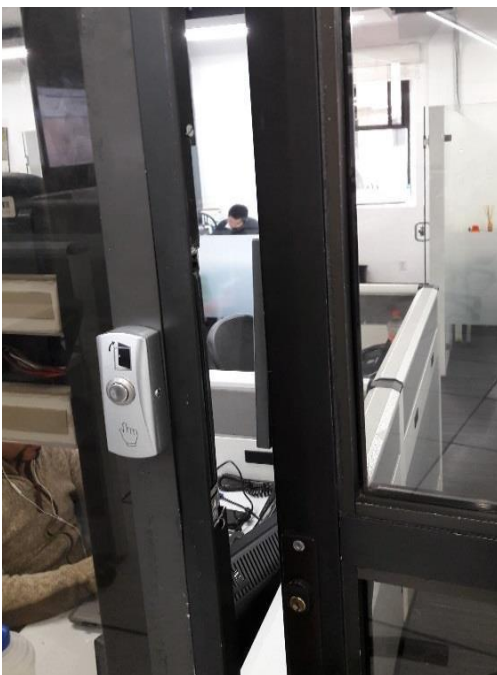
Fig. 17 La entrada principal del Centro de Datos presenta un problema con el mecanismo de apertura y cierre. Quedando expuesto el ingreso de personas no autorizadas a este recinto. De igual forma la puerta que da acceso a la planta de emergencia del Centro de Datos esta averiada.
