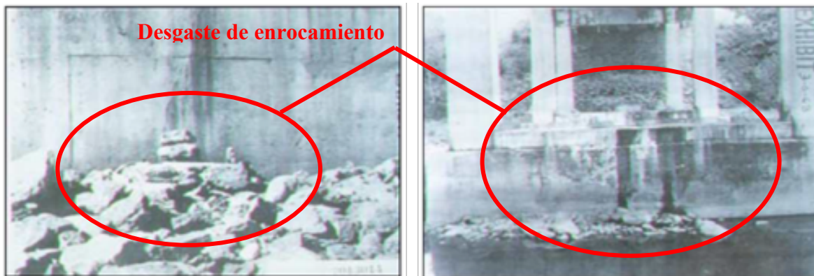
Figura 2.21. Desgaste del enrocamiento de la pila 2 del puente Schoharie de 1956 a 1977 (Dos Santos, 2008)
