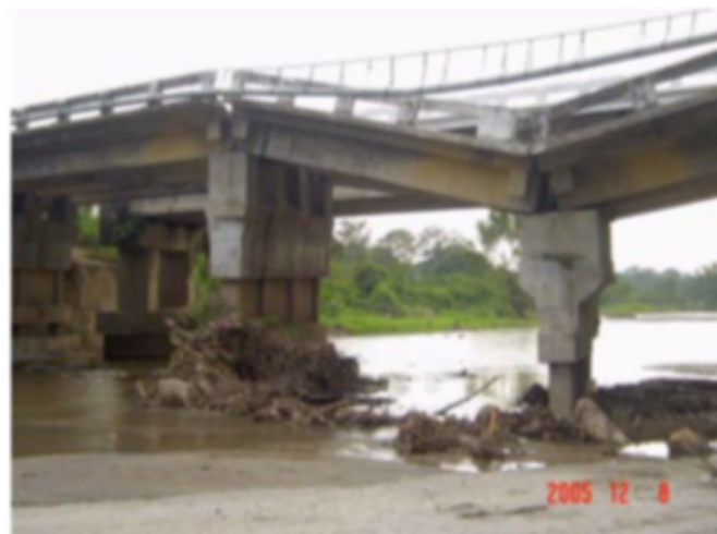
Figura 2.10. Daño en la superestructura del puente Tepuzapa por asentamiento de uno de sus apoyos (Rivera, Echavarría y Pacheco, 2006)
