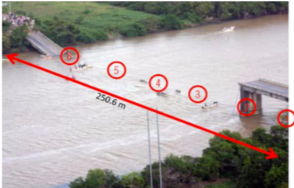
Figura 2.11. Colapso del Puente Tonalá (www.terra.com.mx)
