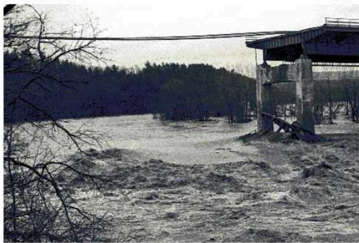
Figura 2.20. Caída de la pila 3 y de los tramos adyacentes (Dos Santos, 2008)
