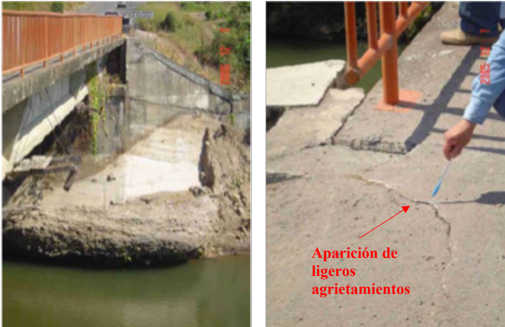
Figura 2.1. Daños en el Puente Texcuyuapan (Rivera, Echavarría y Pacheco, 2006)
