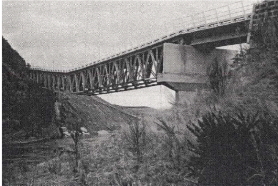
Figura 2.18. Puente Blackmount después del accidente (Dos Santos, 2008)
