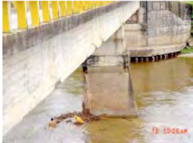
Figura 2.26. Desplazamiento de pilas en el puente Banadia en Colombia (Guerrero, 2016)
