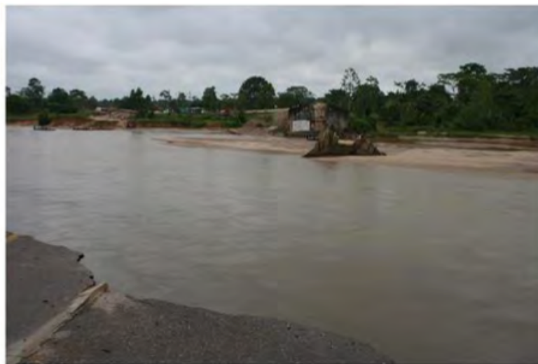
Figura 2.27. Colapso total del puente Banadia (www.ricuc.cl)
