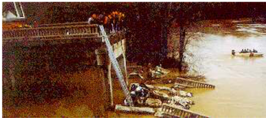
Figura 2.22. Colapso de uno de los tramos del puente el río Hatchie ( www.fhwa.dot.gov )
