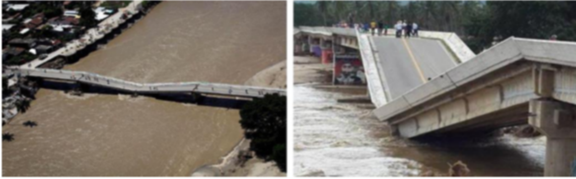
Figura 2.12. Colapso del tramo central del puente Coyuca de Benítez ( www.eluniversal.com.mx )
