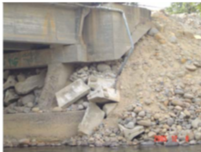
Figura 2.7. Daño en uno de los apoyos del puente Huehuetan (Rivera, Echavarría y Pacheco, 2006)
