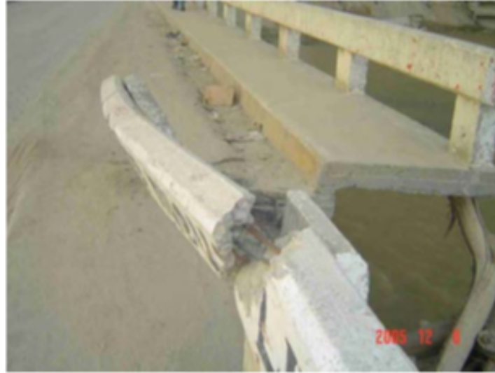
Figura 2.3. Daños en el puente Huixtla ante el paso del huracán Stan (Rivera, Echavarría y Pacheco, 2006)
