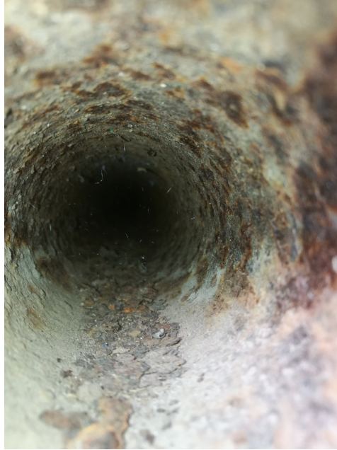
Fig 3.2 Corrosión en la pared interna de un ducto
