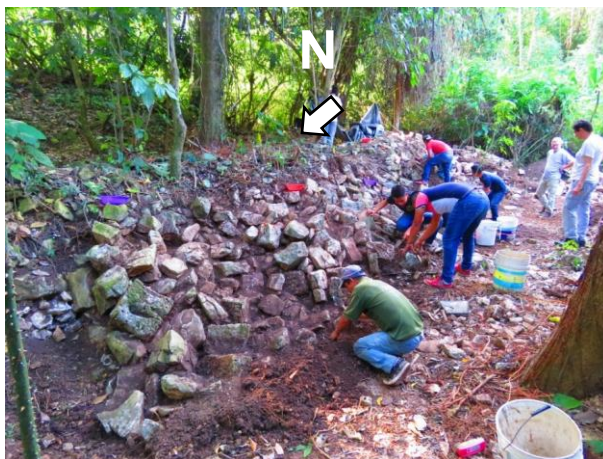
Figura 4.6. Locus 2, derrumbe del muro posterior de la estructura J3. Fotografía del autor.
