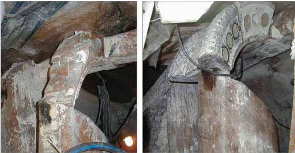
Figura 3.33 Rastrel: Herramienta de corte antes de ser reparada (a la izquierda) y luego de ser reparada (a la derecha). Túnel del Metro de Porto. (NIELSEN, 2006 recuperado de GONZÁLEZ, 2014)
