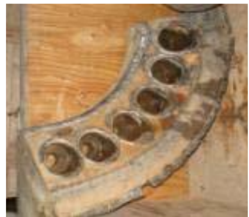
Figura 3.34 Rastrel desgastado. (GONZÁLEZ, 2014)
