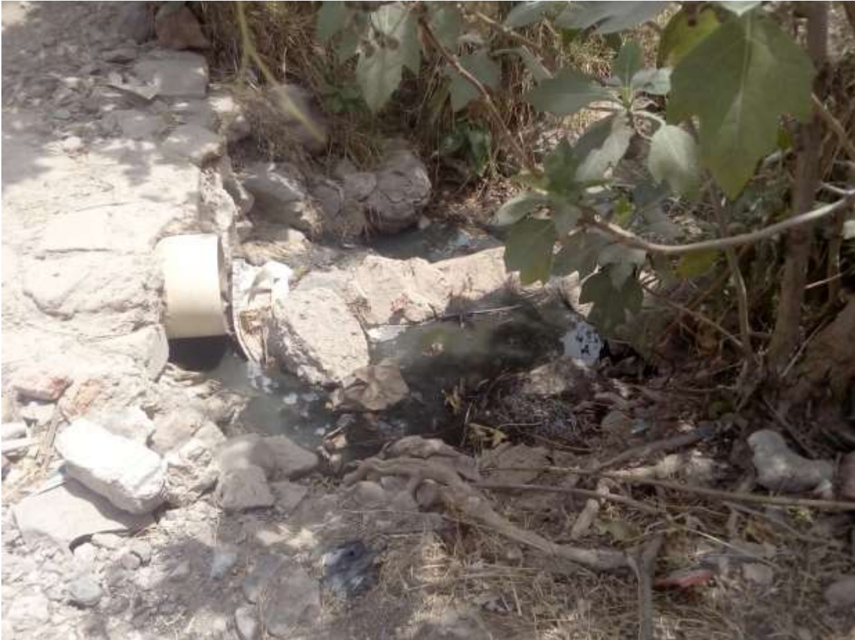
Figura 03.11: Vertido de aguas negras en la comunidad de estudio Fuente: Arias Martínez A. (Fotografía amateur, documental 2018)
