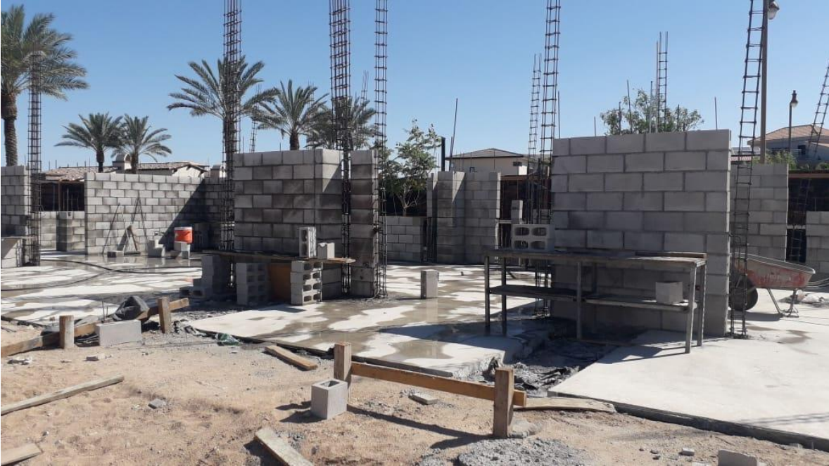
Imagen 24 Avance de colocación de block y acero de refuerzo vertical para castillos.
