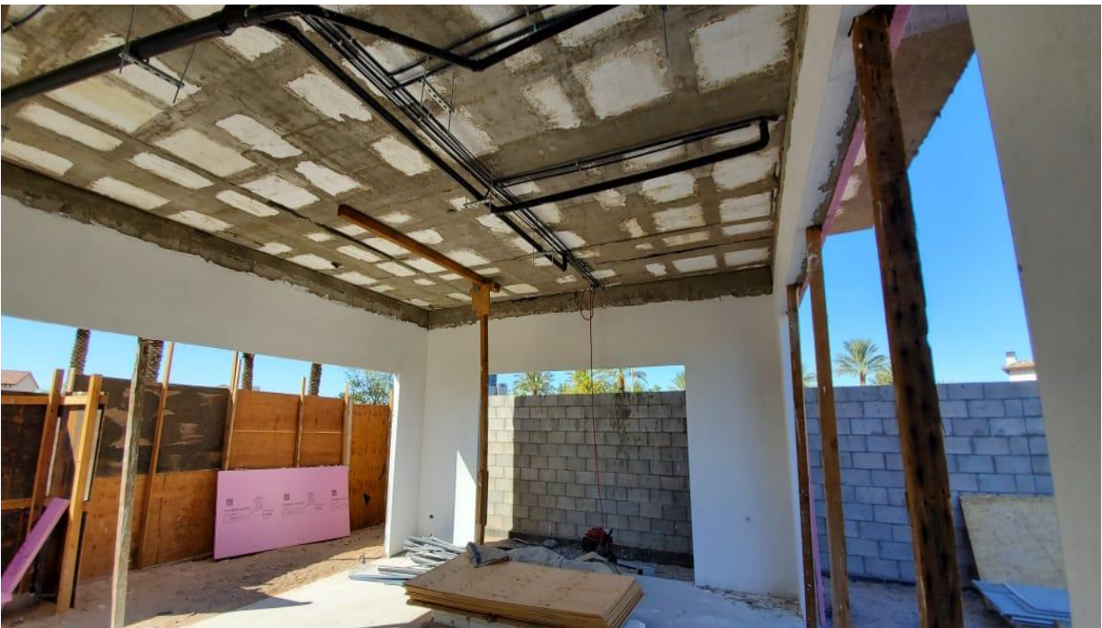
Imagen 31 Instalaciones hidráulicas fijadas al lecho inferior de losa.
