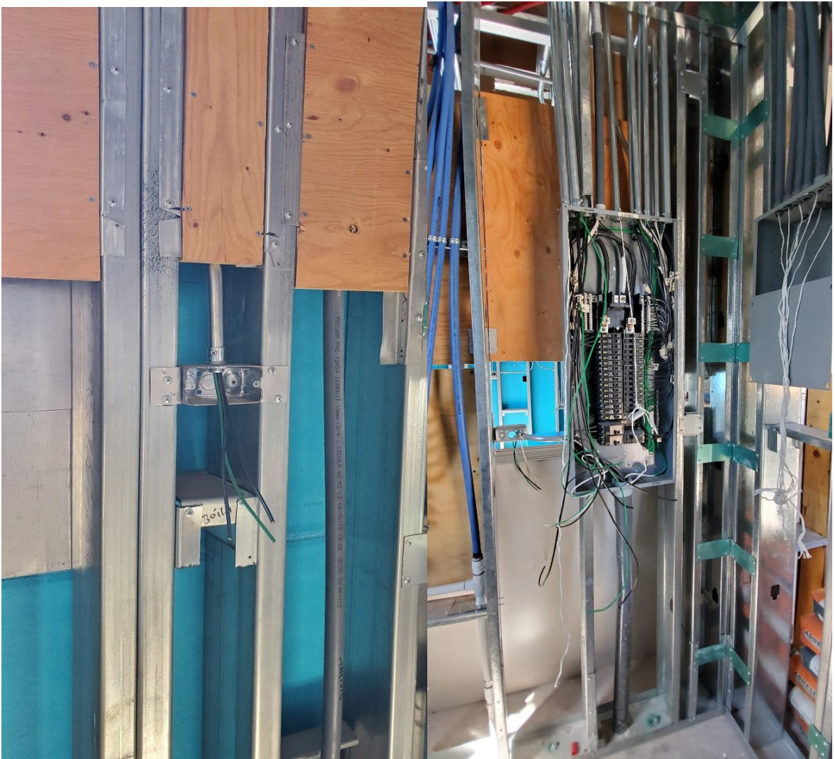
Imagen 13 Centro de carga principal
