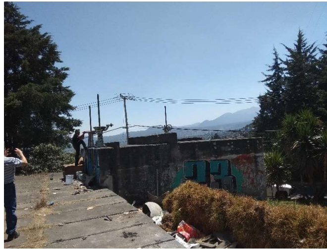
Figura II-8 Caja de válvulas a la entrada del tanque
