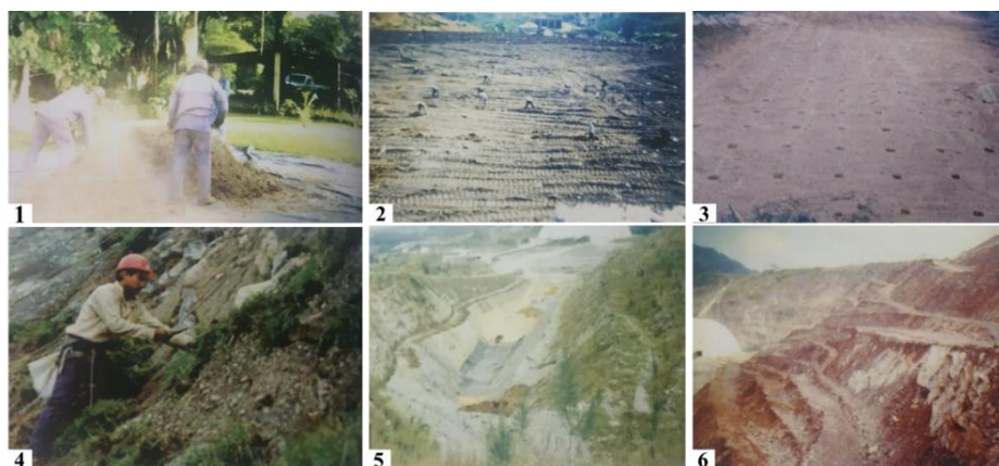
Figura 5.12. Acciones de rehabilitación realizadas en el proyecto Holcim Apasco. 1) Combinación de composta con semillas de plantas herbáceas. 2) Distribución de 10 cm de composta con semillas en los terrenos con poca pendiente. 3) Diseño de plantación y cepas de manera regular. 4) Instalación de estacas en taludes para el establecimiento de pasto estrella para evitar introducción de semillas. 5) Colocación de cubierta plástica impermeable sobre la arcilla compactada para formación de lago artificial. 6) Construcción de terrazas en los taludes de 21 grados. Fotografías de Fragoso y Rojas 2012.
