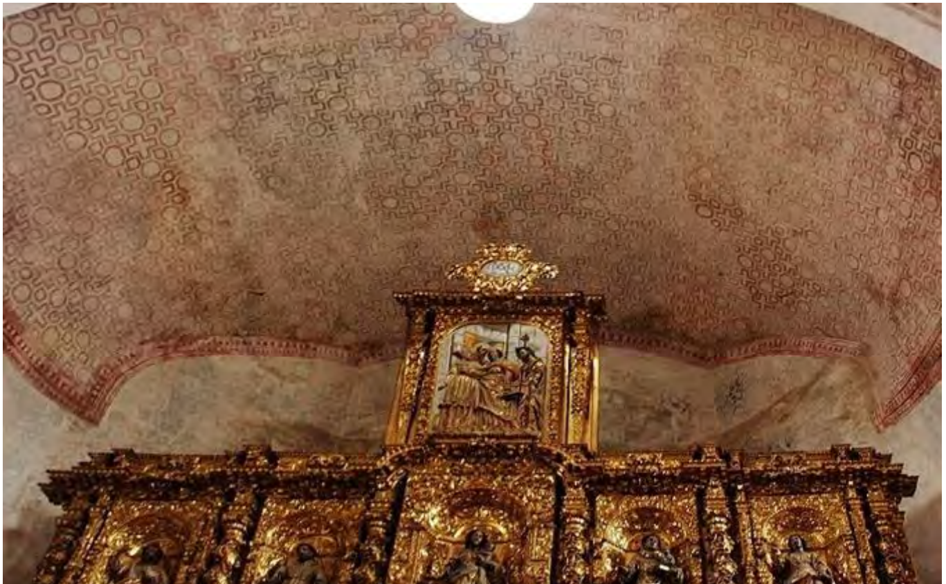
Ilustración 7.23. Casetones serlianos en el ábside de la iglesia de San Luis Tlalmanalco, Estado de México.
