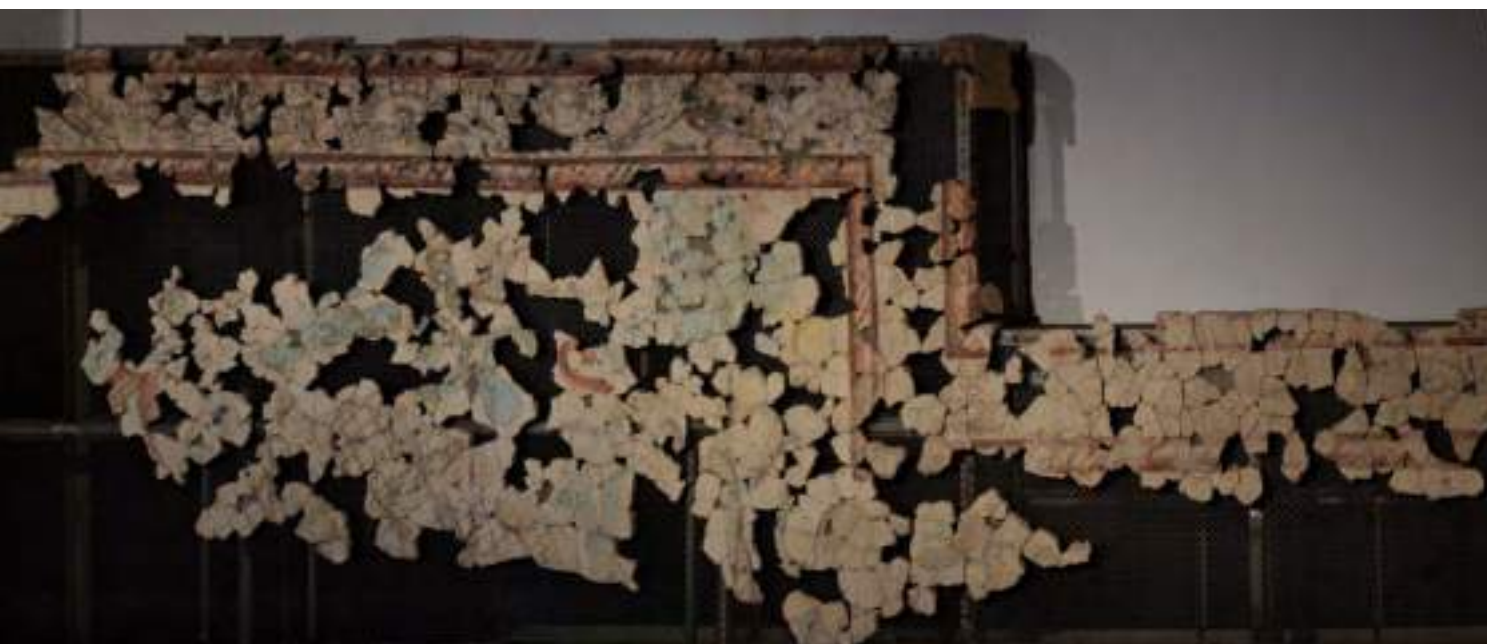
Ilustración 5.16. Fragmentos de pintura mural desprendidos y depositados en el interior de la caja de agua del colegio de Santa Cruz de Tlatelolco, Ciudad de México. Fotografía Aban Flores Morán (2015).
