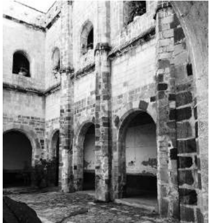
Ilustración 6.7. Contrafuertes y muros elaborados con sillares en el convento de la Inmaculada Concepción de Zacualpan de Amilpas, Morelos. Extraída de: https://www.puntopuntotv.com/2015/08/15/zacualpan-de-amilpas-la-joya-tur%C3%ADstica-de-morelos-que-debemos-conocer/
