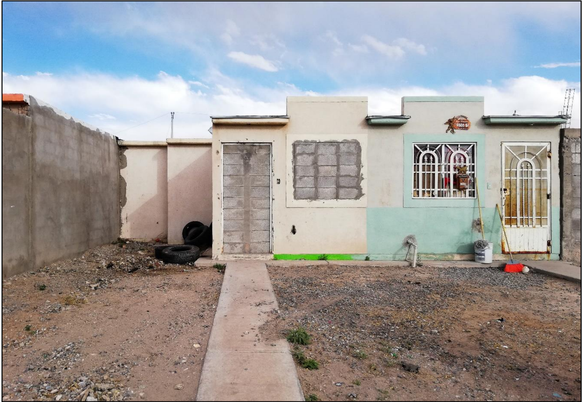
Imagen 6.21 y 6.22. Viviendas bloqueadas
