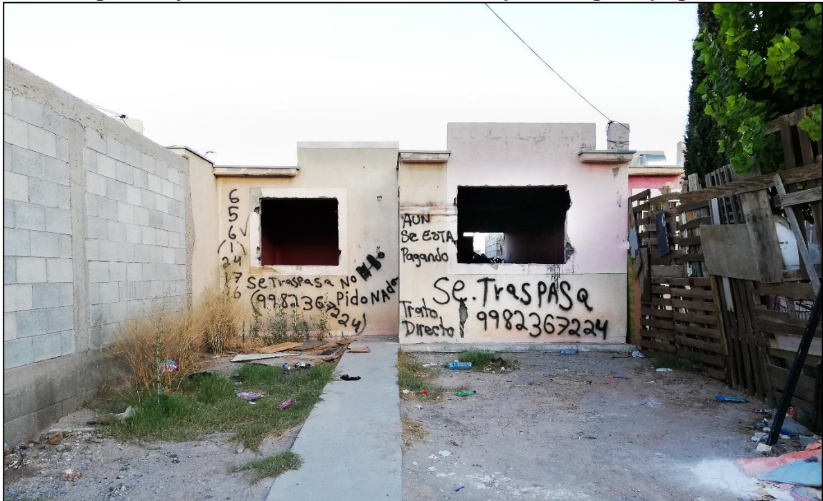
Imagen 6.1 y 6.2. Viviendas deshabitadas que se siguen pagando
