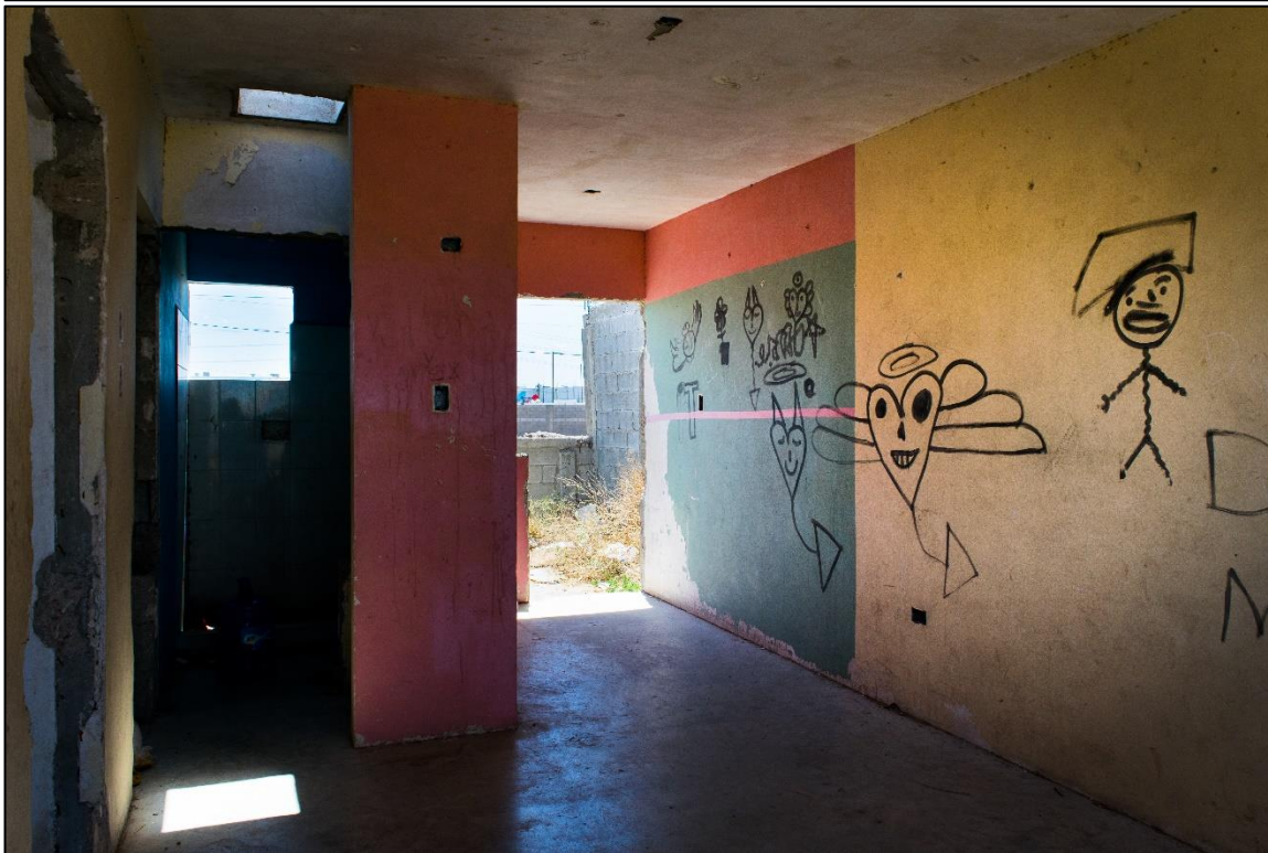
Arriba interior de vivienda vandalizada en Senderos de San Isidro, abajo interior de vivienda vandalizada en Las Haciendas.
