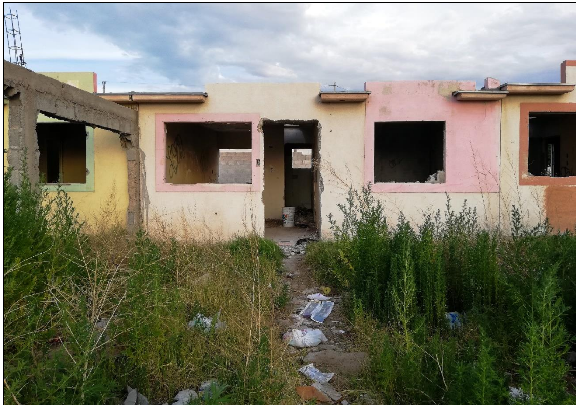
Viviendas deshabitadas convertidas en tiraderos de basura. Arriba Senderos de San Isidro, abajo Las Haciendas.
