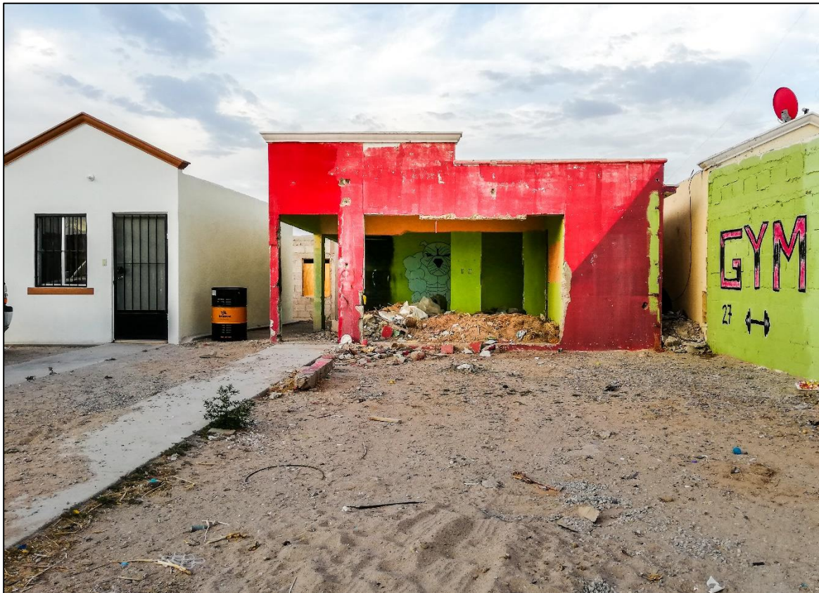
Arriba y abajo las mismas dos viviendas en Senderos de San Isidro. Tomadas el 18 de mayo de 2019 (arriba) y el 01 de julio del mismo año (abajo).
