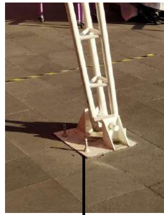
Elementos estructurales velaria CNA. Anclaje de columna a cimentación mediante una articulación construida a base de placas de acero, mismas que están ancladas a esparragos ahogados en la cimentación. Foto Melissa Delgado
