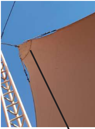
Elementos estructurales velaria CNA. Columnas de acero con refuerzo al centro de la sección para resistir esfuerzos a compresión. Foto Melissa Delgado
