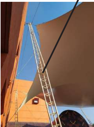
Elementos estructurales velaria CNA. Anclaje de columna a velaria mediante placa de acero perforada. Foto Melissa Delgado
