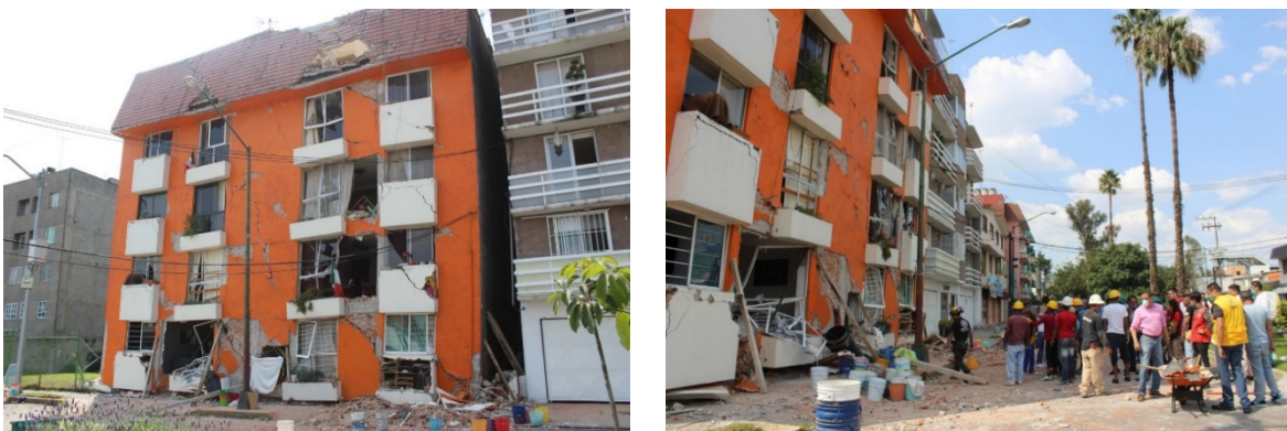
Fig. 2.1.2 Edificio después del sismo del 19 de septiembre de 2017.
