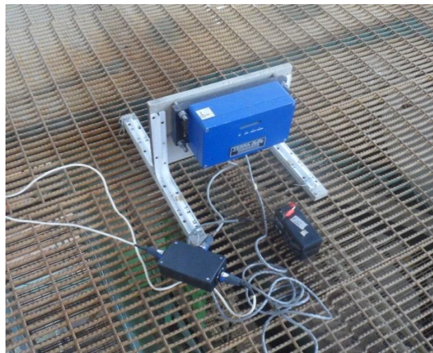
Fig. 5.3. Equipo de medición SSA-320, Terra Technology (Ayala y García, 2015)
