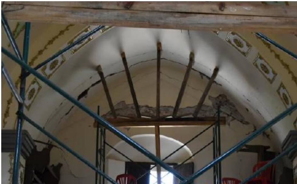
Figura 3.21. Grietas en la conexión Fachada principal-nave central
