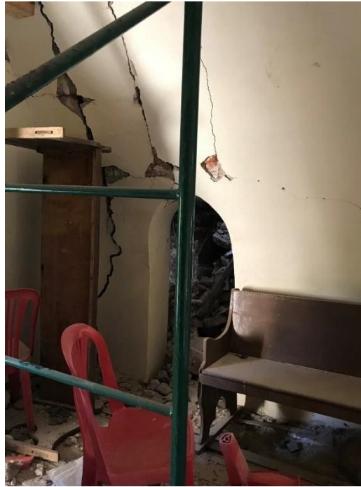
Figura 3.26. Grietas verticales por tensión en la unión bóveda-torre
