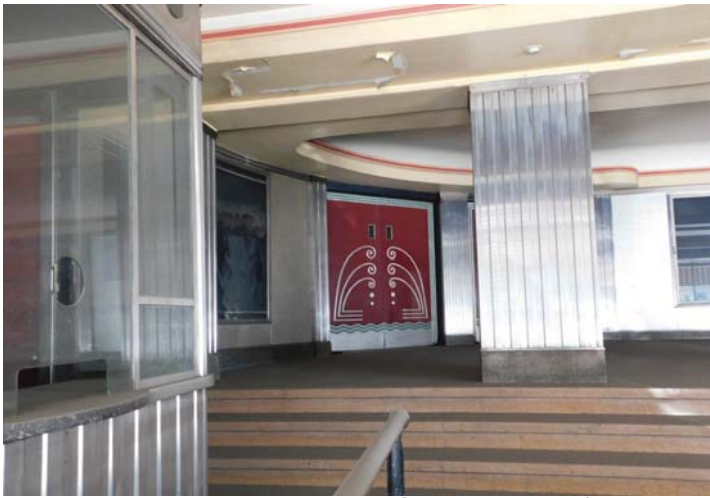
Figura 5.13 Daños en plafón interior
