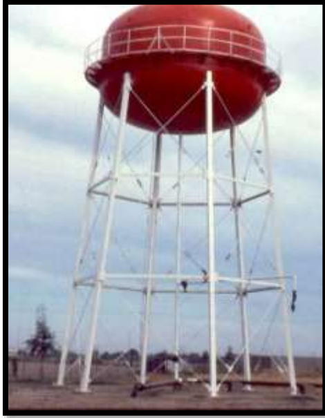
Figura 11. Tanque elevado [Tecnotanques, 2017].
