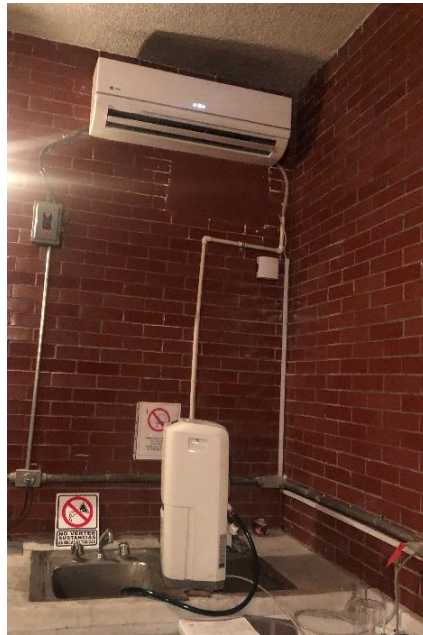
Figura 33 En la parte inferior se observa el deshumidificador y arriba se encuentra el aire acondicionado
