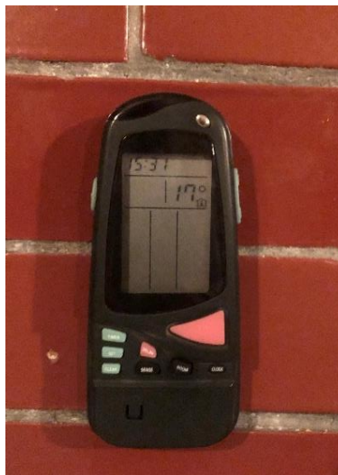
Figura 34. Termómetro electrónico instalado en el laboratorio; marca Trane
