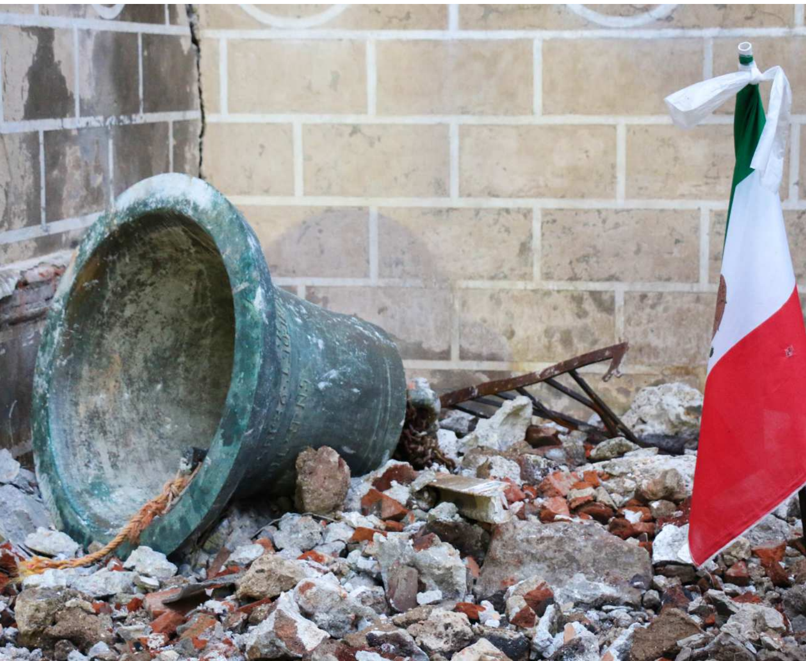
Fotografía 52. Destrucción afuera del templo de San Guillermo Totolapan [Foto: Caritas Mexicana]. (Totolapan, 2017) Recuperado de: https://cutt.ly/6rNfan1
