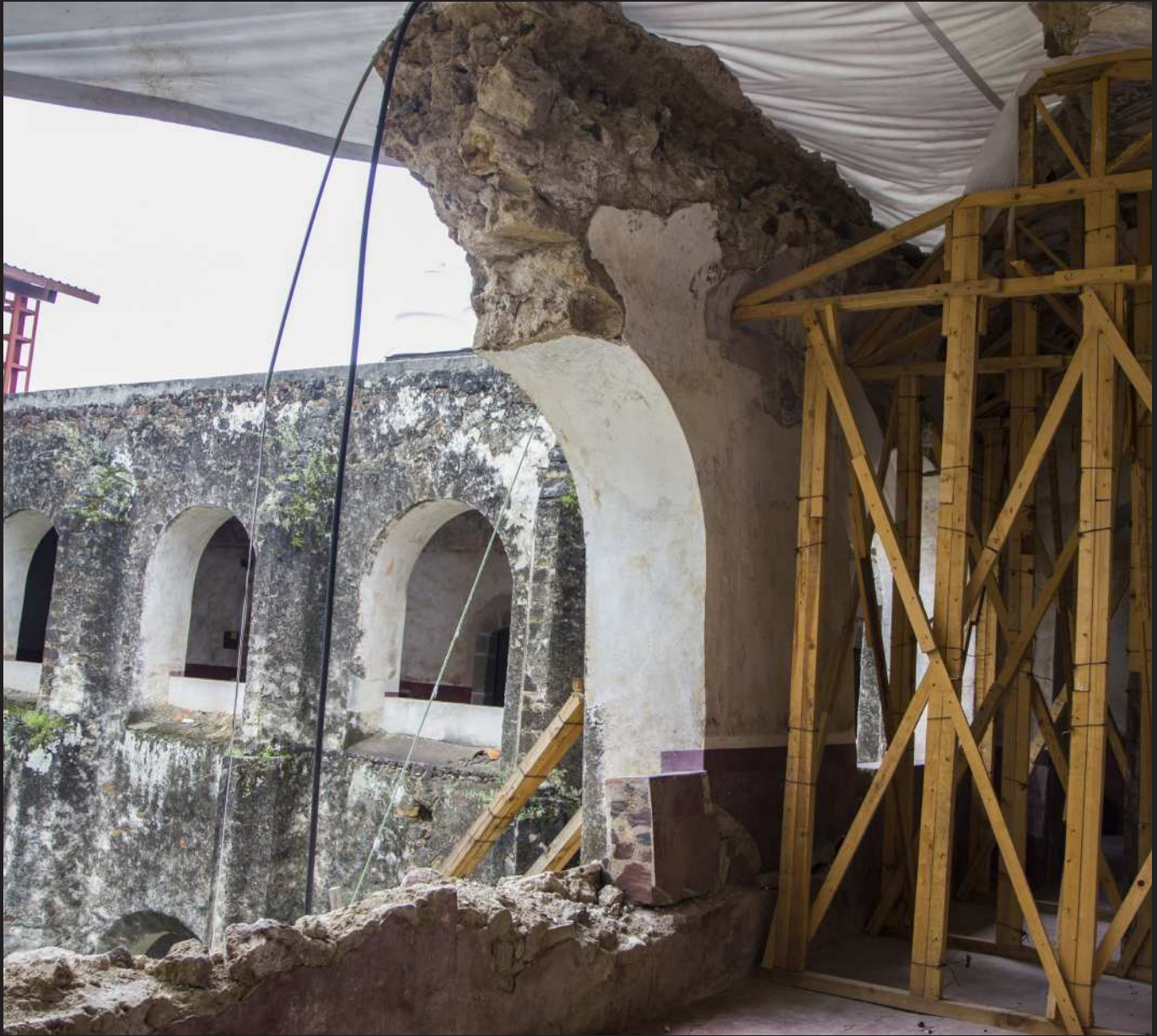
Fotografía 79. Derrumbe de pasillo en el Ex convento de San Guillermo Totolapan Fotografía: Laura Casariego (2018)
