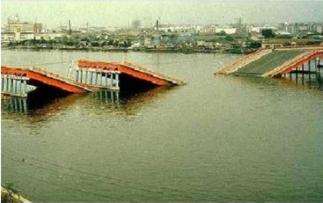
Figura 1.8. Colapso del puente Showa por desplazamiento lateral. Niigata, 1964.
