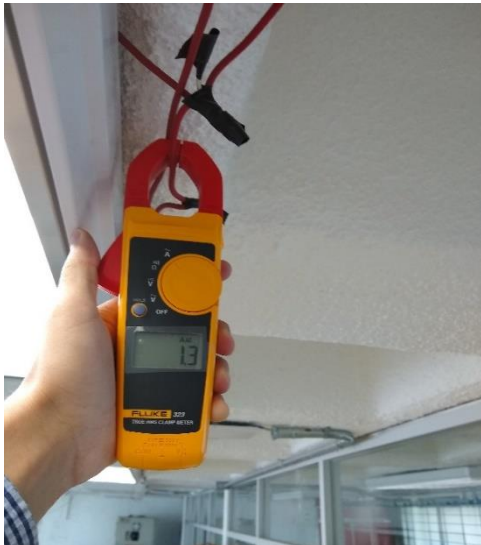
Figura 10. Corriente en luminaria fluorescente 1 Fotografía tomada en el Laboratorio L3.
