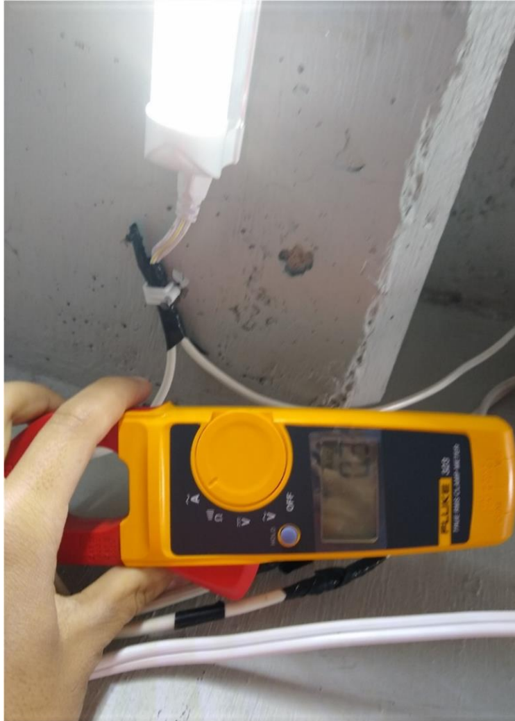
Figura 9. Corriente eléctrica de lámpara Montana.
