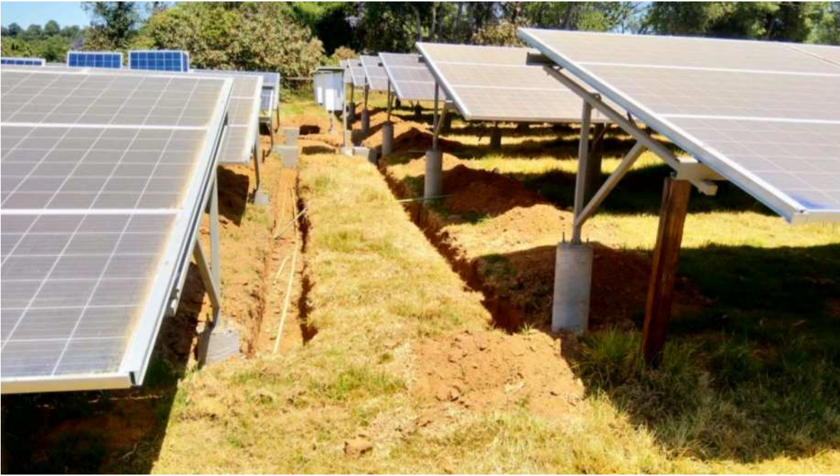
Imagen C. 43. Canalización, cableado y tubería.
