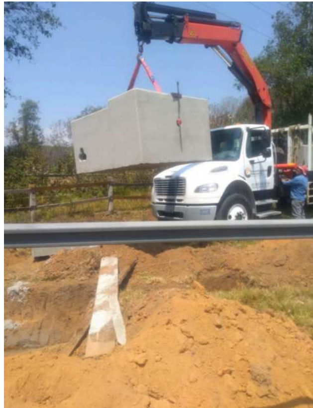
Imagen C. 41. Suministración de los registros de concreto prefabricado de diferentes dimensiones. Su descarga se hizo por medio de grúa articulada en el área definida para el proyecto.
