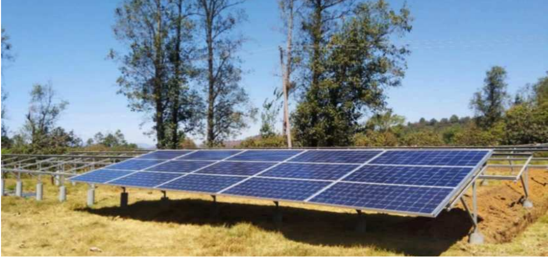
Imagen C. 42. Acomodo de los módulos solares.
