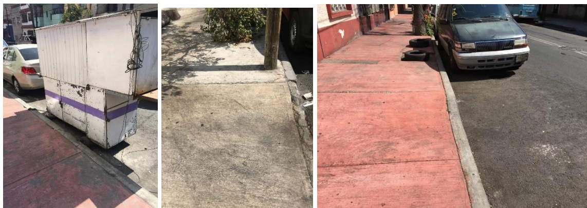
FIGURA 57. Muestra de las condiciones de las banquetas en la Colonia Pro-Hogar. Fuente: Elaboración propia (2019).
