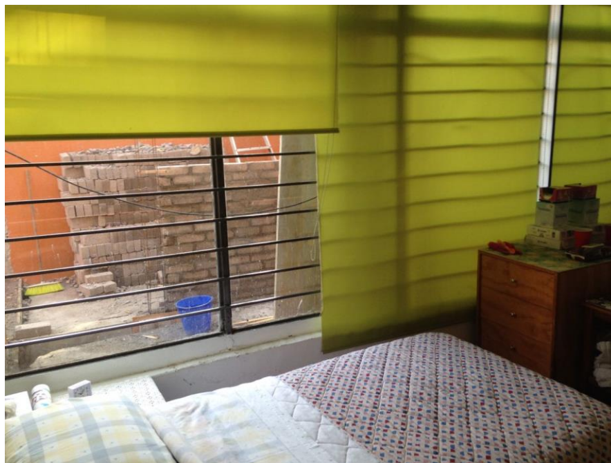
Imagen 4. Estado antes de la remodelación. En la imagen se muestra que a pesar de ser orientación norte la habitación contaba con un gran ventanal que favorecía la poca confortabilidad térmica.
