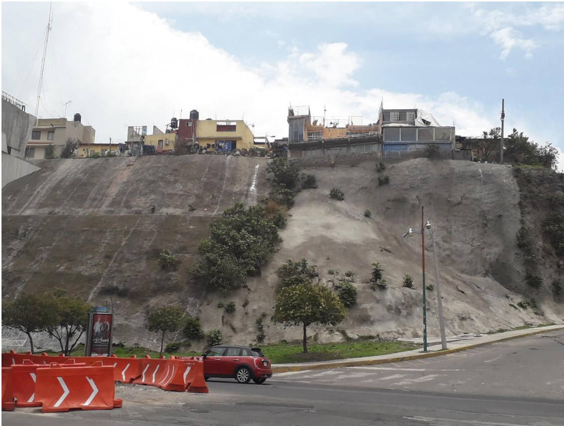
Fotografía 3. Manejo de laderas inestables en la Av. Vasco de Quiroga en la Ciudad Santa Fe.
