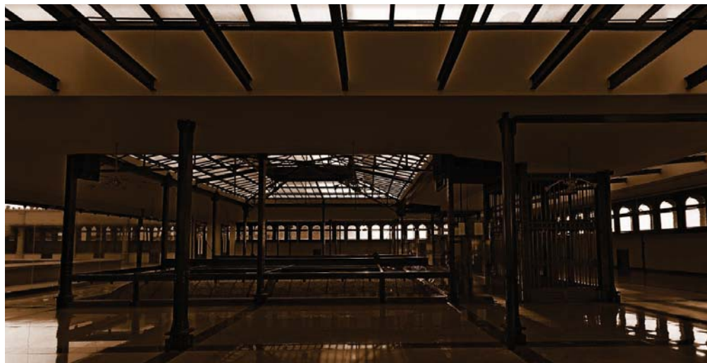
Gráfico 138. Entramado de vigas a traves principales y columnas del tercer nivel. Foto: Jorge Vázquez.
