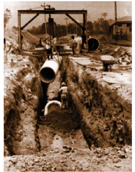
Gráfico 19. Trabajadores durante la construcción de drenaje profundo en la Cd. de México. (Casasola, 1968).
