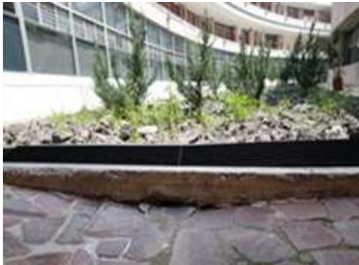
Ilustración 15. Contreras, Nayeli (2018) ,Desniveles en coladeras entre Edificio E Y G. [Fotografía]. Fuente: propia.
