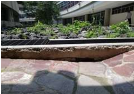
Ilustración 17. Contreras Nayeli (2018) Desniveles en coladeras entre Edificio E y G [Fotografía] Fuente: propia
