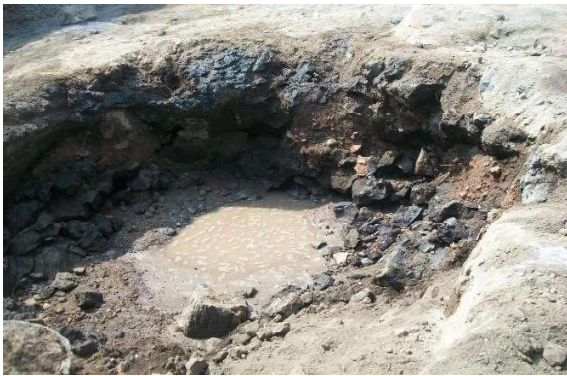
Ilustración 9. Contreras, Nayeli (2018), Pozo a cielo abierto. Terreno de desplante Edificio Unidad de Posgrados UNAM. [Fotografía]. Fuente: Dirección General de Obras y Conservación UNAM.
