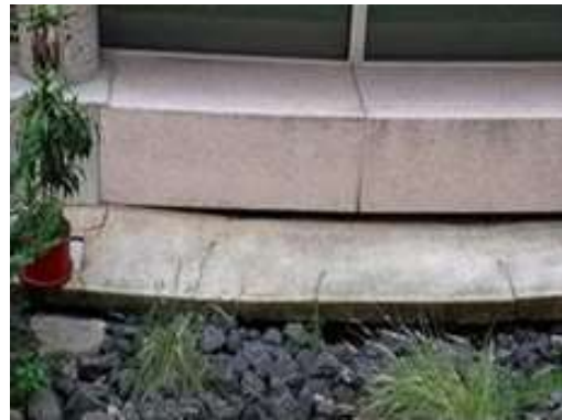
Ilustración 16. Contreras, Nayeli (2018) Desniveles en firmes en Edificio G. [Fotografía]. Fuente: propia
