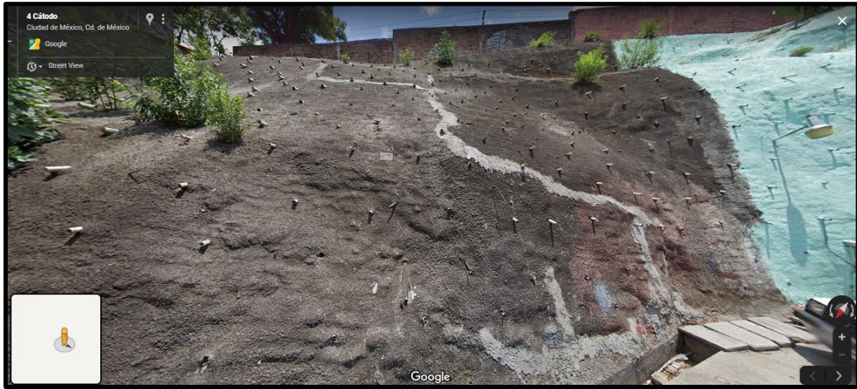
Figura I.4 Vista frontal del talud donde se observa el agrietamiento sobre la pendiente del talud.
