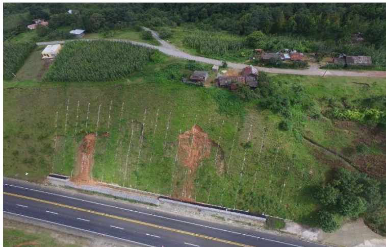
Figura IV.2 Ejemplo de la falla de un talud debido a la falta de drenaje (Dominguez, 2018).
