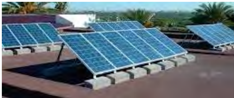
Figura 4-13 Fotografía de modulo instalado (Fuente fotografía obtenida por (JCARDELLS, 2015).
