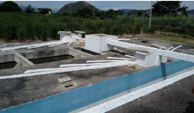
FIGURA 95. Planta de tratamiento de aguas negras perteneciente a la comunidad de Teotitlán del Valle, en esta foto se aprecian las fosas sépticas, la entrada principal de los desechos del sistema de drenajes de la comunidad, a la cual el presente proyecto se conectará.
