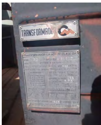
Figura 37. Placa de identificación de transformadores Fuente: SEMARNAT-PNUD, 2009.
