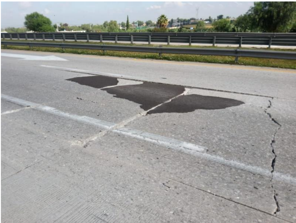
Ilustración 6. Falla en el pavimento de la Autopista Arco Norte. Fuente: tomada en sitio.
