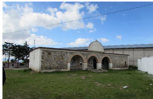
Figura 6. 44 Estado actual del cuerpo de guardia edificado por Pedro Ponce.
