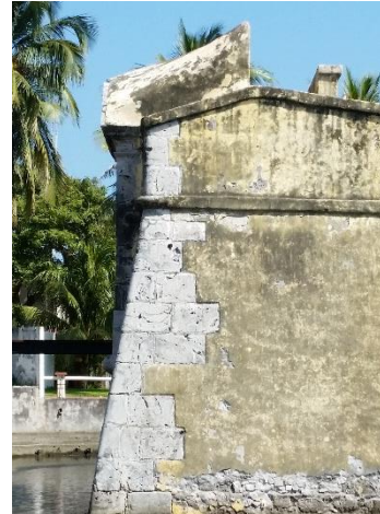
Figura 7. 21 Foto que muestra los sillares en refuerzo de esquinas, comunmente llamados "rafas". Luneto de Ntra. Sra. Del Pilar. Obras exteriores de San Juan de Ulúa.
