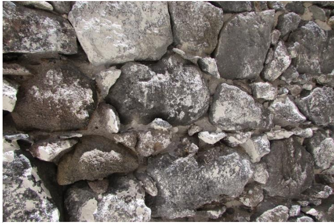
Figura 7. 73 Mampostería irregular en piedra basáltica de la región de Perote. Detalle en muro de edificios militares del suroeste.
