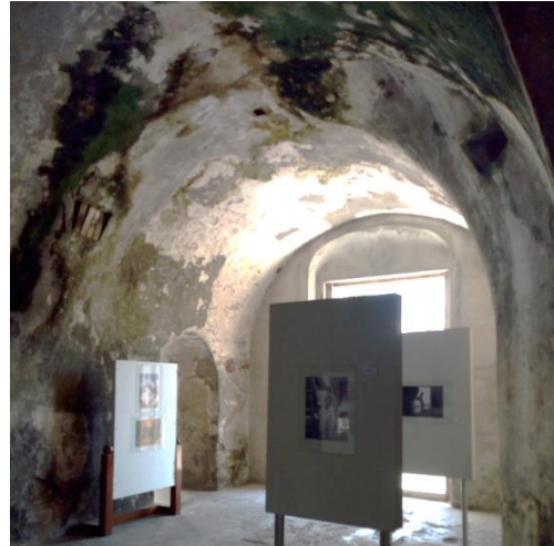
Figura 7. 24 Foto del interior de la casamata donde se observa el desfase del intradós y pies derechos de la bóveda 1
