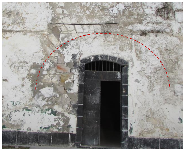
Figura 7. 83 Testimonio de las dos roscas de la bóveda de una casamata en la cortina oriente
