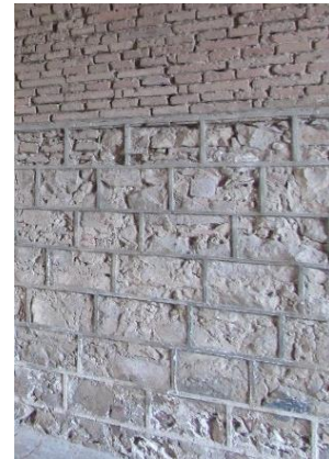
Figura 4. 19 Mampostería ordinaria de piedra sedimentaria arenisca que, por la irregularidad visible sin aplanado, en una intervención contemporánea se le ha sobrepuesto una junta aparentando la conformación de sillares.
