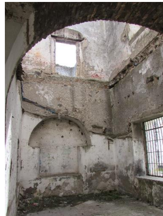
Figura 6. 54 Pérdida de estructuras de entrepiso en edificios militares
