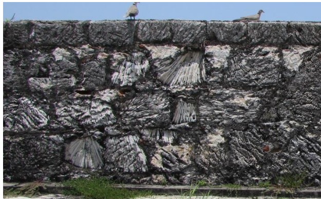
Figura 7. 19 Paño interior del parapeto del revellín de San José.
