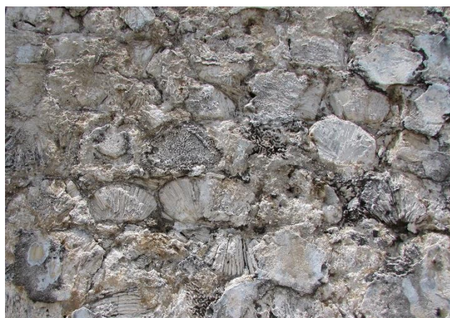
Figura 7. 17 Paramento exterior del muro que conforma el revellín de San José en donde se aprecia la intención de regularizar las hiladas del coral.
