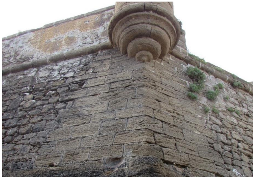
Figura 4. 14 Detalle de la diferencia de cortes en la piedra ostionera para su colocación en las murallas del Fuerte de San Sebastián. Además, se aprecia la erosión de las superficies y juntas de mortero por la exposición de los continuos vientos que azotan la costa.
