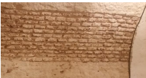
Figura 4. 34 Fragmento sin aplanado en la bóveda de la galería de minas en San Carlos de la Cabaña. La disposición del ladrillo en de las piezas a tizón corresponde al llamado aparejo español.
