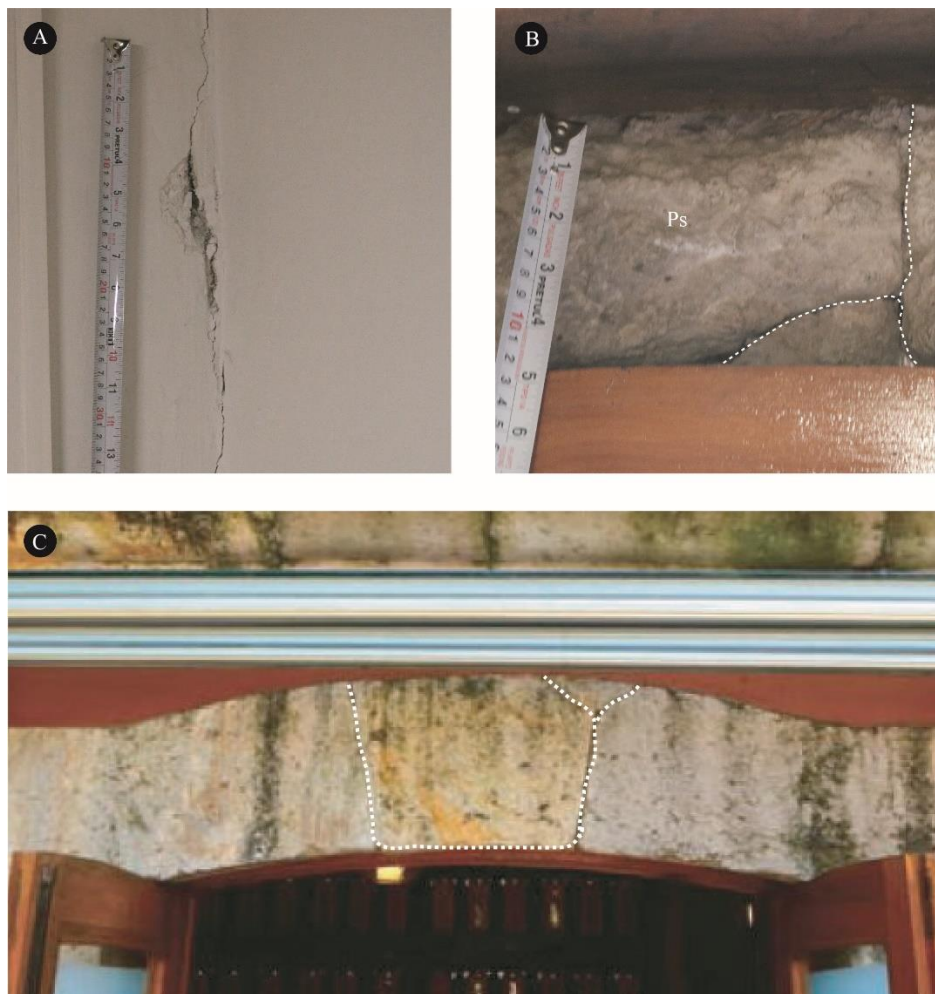
Figura 44 Grietas características del centro cultural universitario. A) Grieta en aplanados en los muros del edificio. B) Grietas sobre ventana de sótano. C) Grieta en pórtico del edificio.
