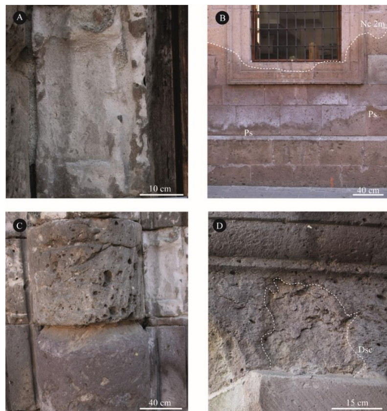
Figura 1. Patologías encontradas en las rocas que comprenden el corpus de los edificios del centro histórico de la ciudad de Morelia. A) Erosión diferencial. B) Precipitación de sales y ascenso capilar. C) Erosión diferencial. C) Descamación. Nomenclatura, Dsc: Descamación, Nc: Nivel máximo de ascenso capilar, Ps: Precipitación de sales.
