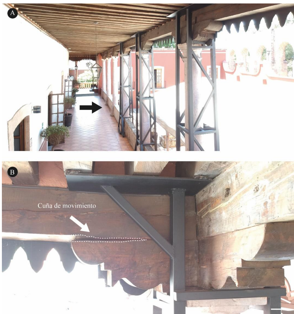
Figura 42 Patologías principales encontradas en los recorridos visuales del centro cultural universitario. A) Vista general del pórtico. B) Viga principal donde se percibe desplazamiento.
