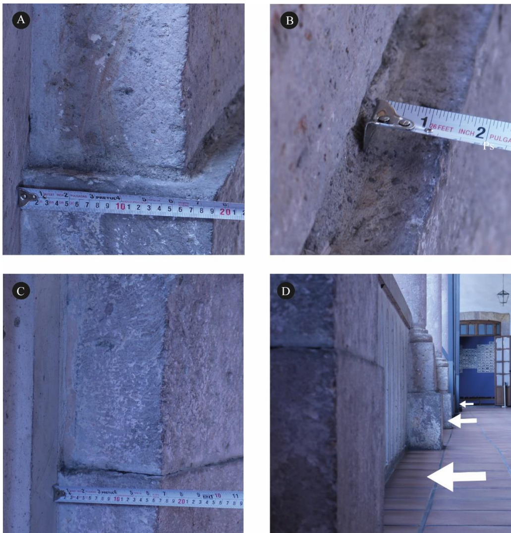
Figura 43 Movimiento general de las columnas del p rtico. Las im genes A, B Y C, representan el desplazamiento iniciando de la columna Oeste hasta la columna Este. D) Movimiento general de las columnas.
