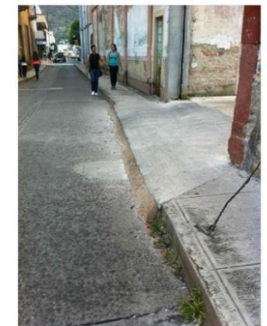
F12- Fotografía 12. Rampa invadiendo paso peatonal, flora parásita y cable de acero post-tensado anclado a la banqueta.
