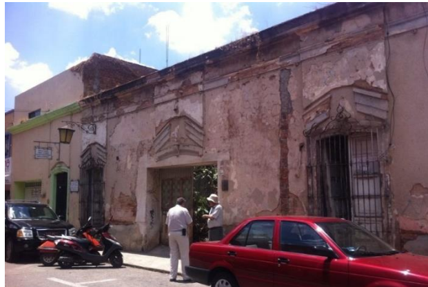
Imagen 73. Inmueble del siglo XIX-XX. Calle 20 de noviembre, Atotonilco el Alto. Inmueble en estado de abandono. Fuente: Diana FS 2015.
