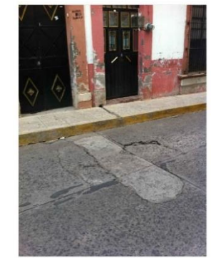
F11- Fotografía 11. Emplastos de cemento sobre carpeta asfáltica.
