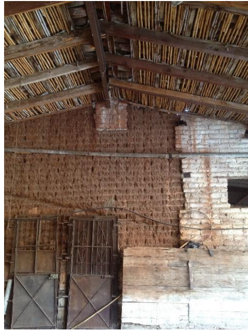
Imagen 42. Muro de adobe en Troje, se distingue el apoyo de tabique rojo recocido en carga puntual de viga. Fuente: Diana FS 2015.
