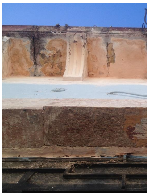
Imagen 82. Desprendimiento y pérdida de aplanado en lecho bajo de ménsula de cantera, perteneciente a un inmueble del siglo XIX-XX. Se aprecia el color ocre del aplanado. Fuente: Diana FS 2016.
