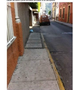
F13- Fotografía 13. Cambio de acabado en banquetas.
