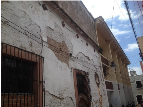
Imagen 72. Inmueble del siglo XIX. Calle Prisciliano Sánchez. Atotonilco el Alto. Se muestran los deterioros más frecuentes en inmuebles de valor patrimonial: agregado posterior, desprendimiento y pérdida de aplanado, fábricas de muros expuestas, y vano tapiado. Fuente: Diana FS 2016.
