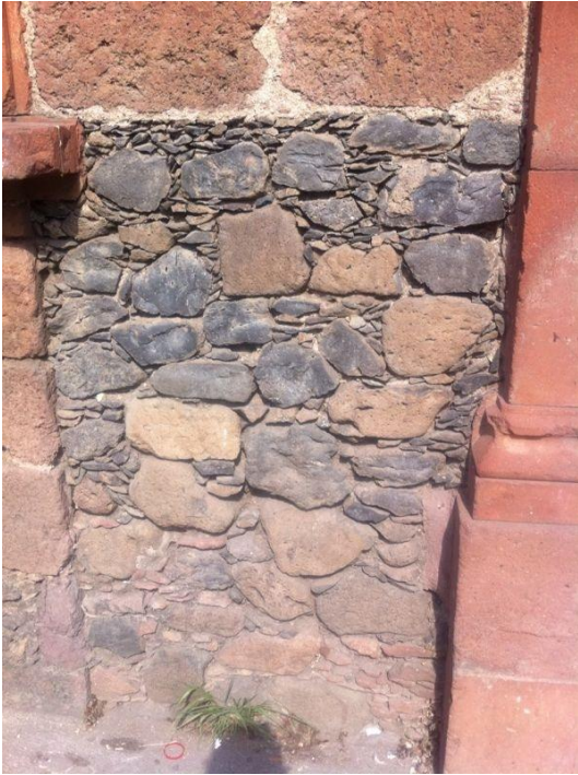
Imagen 35. Desplante de piedra braza en vivienda del s. XIX. Atotonilco el Alto. Fuente: Diana FS 2016.
