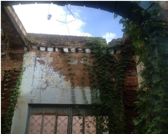
Imagen 74. Interior de imagen 5. El inmueble presenta pérdida de cubiertas, de aplanados, y crecimiento de vegetación parásita. Fuente: Diana FS 2016.
