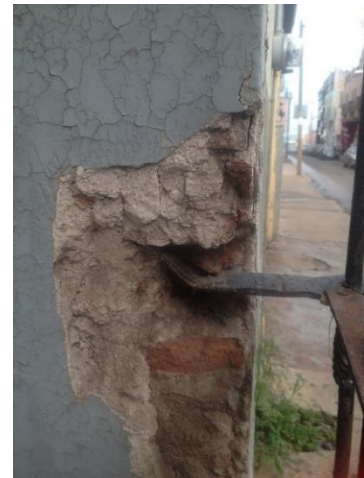
Imagen 48. Sistema de anclaje expuesto por deterioro en Tepatitlán, Jal. Fuente: Diana FS 2015.
