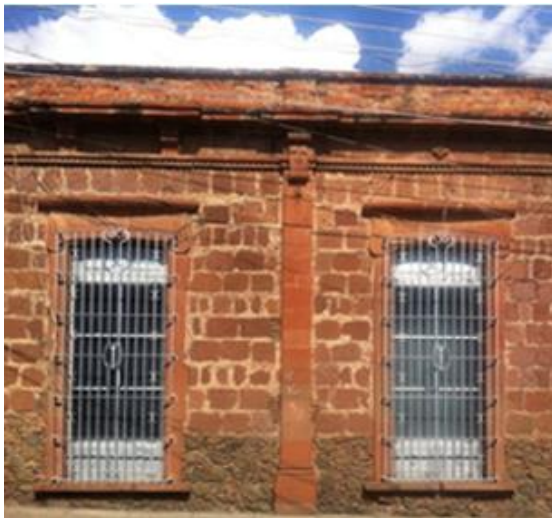
Imagen 37. Muro de sillares de tepetate con desplante de piedra braza en fachada de vivienda del siglo XIX. Atotonilco el Alto Fuente: Diana FS 2016.
