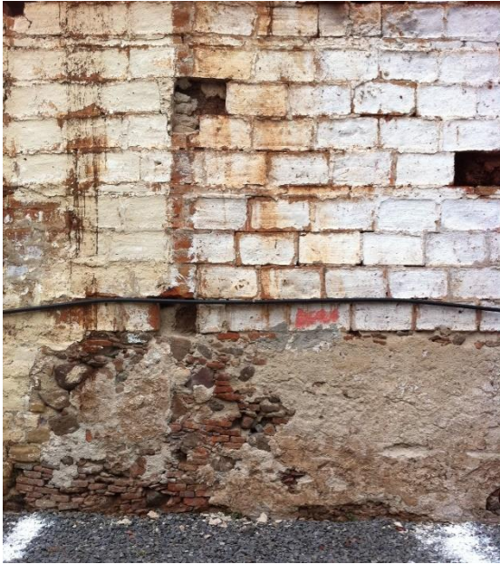
Imagen 31. Desplante de muro de limosna, muro de adobe con recubrimiento de ladrillo rojo recocado. Fuente: Diana FS 2014
