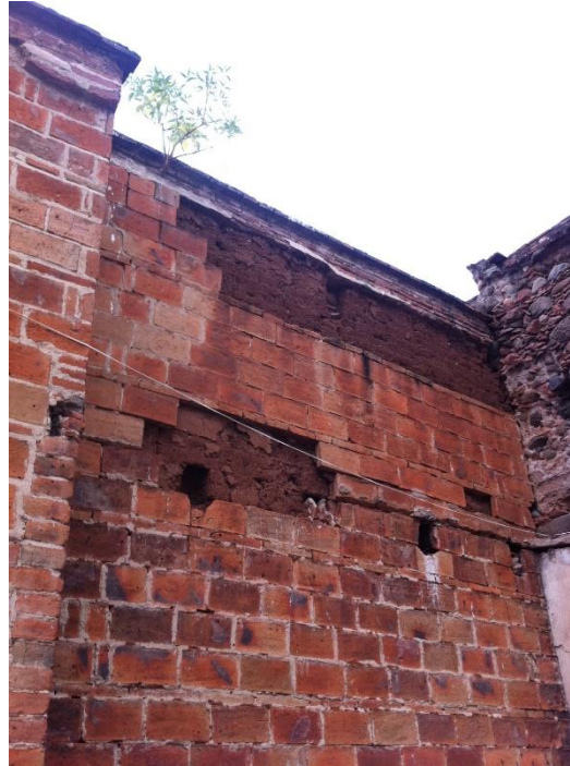
Imagen 36. Muro de adobe con recubrimiento de ladrillo rojo recocado en vivienda del siglo XIX. Atotonilco el Alto. Fuente: Diana FS 2016.
