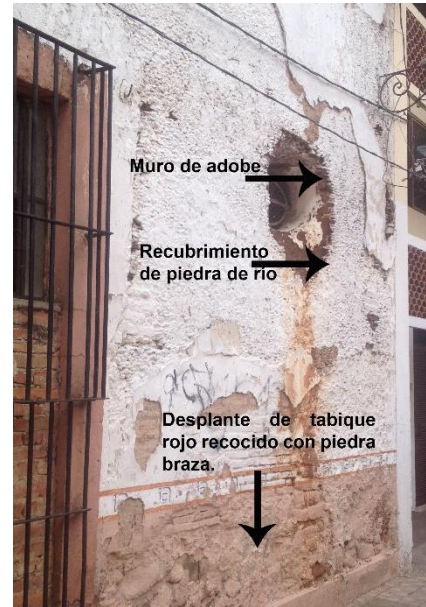
Imagen 32. Desplante de muro de tabique rojo recocado con piedra braza, muro de adobe con recubrimiento de piedra de río. Fuente: Diana FS 2016.
