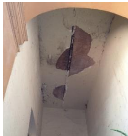
Imagen 52. Cubierta de vigería de acero y bóveda de tabique incorporadas posteriormente en casa Morelos 78, Atotonilco el Alto, Jal. Fuente: Diana FS 2014.
