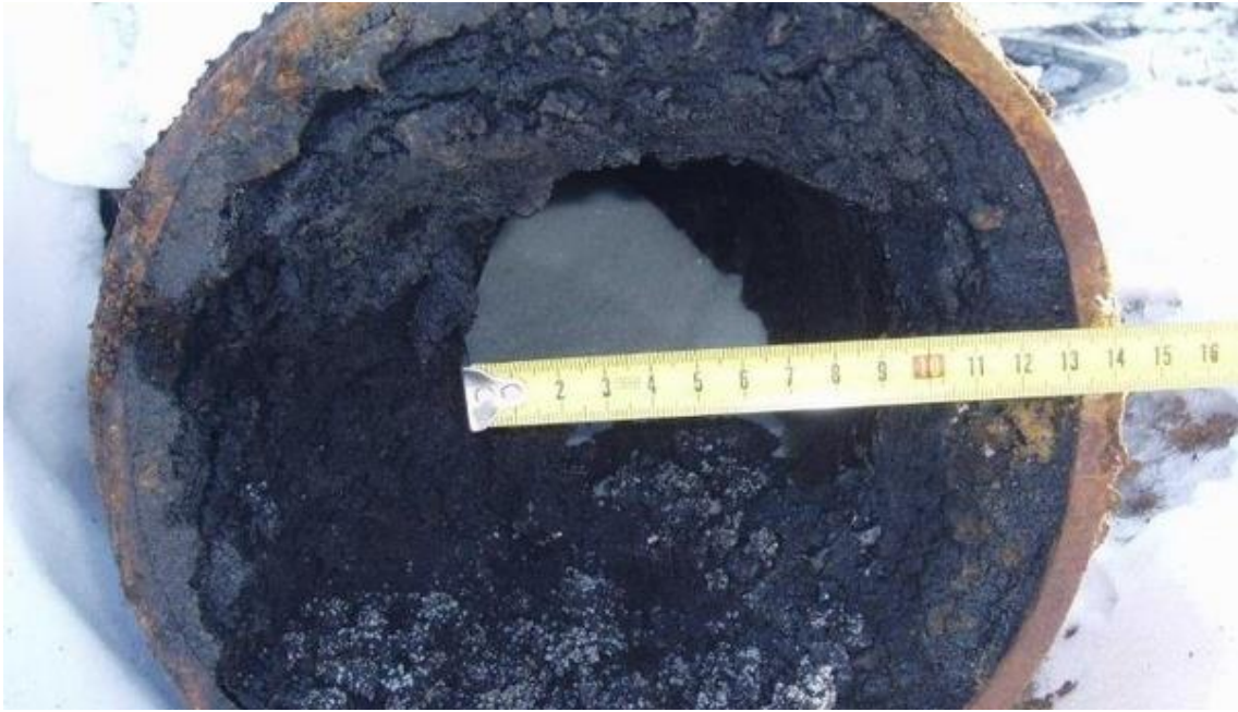
Figura 1.3.2 Precipitación de asfaltenos dentro de una porción de tubería (Narayanan, 2018).
