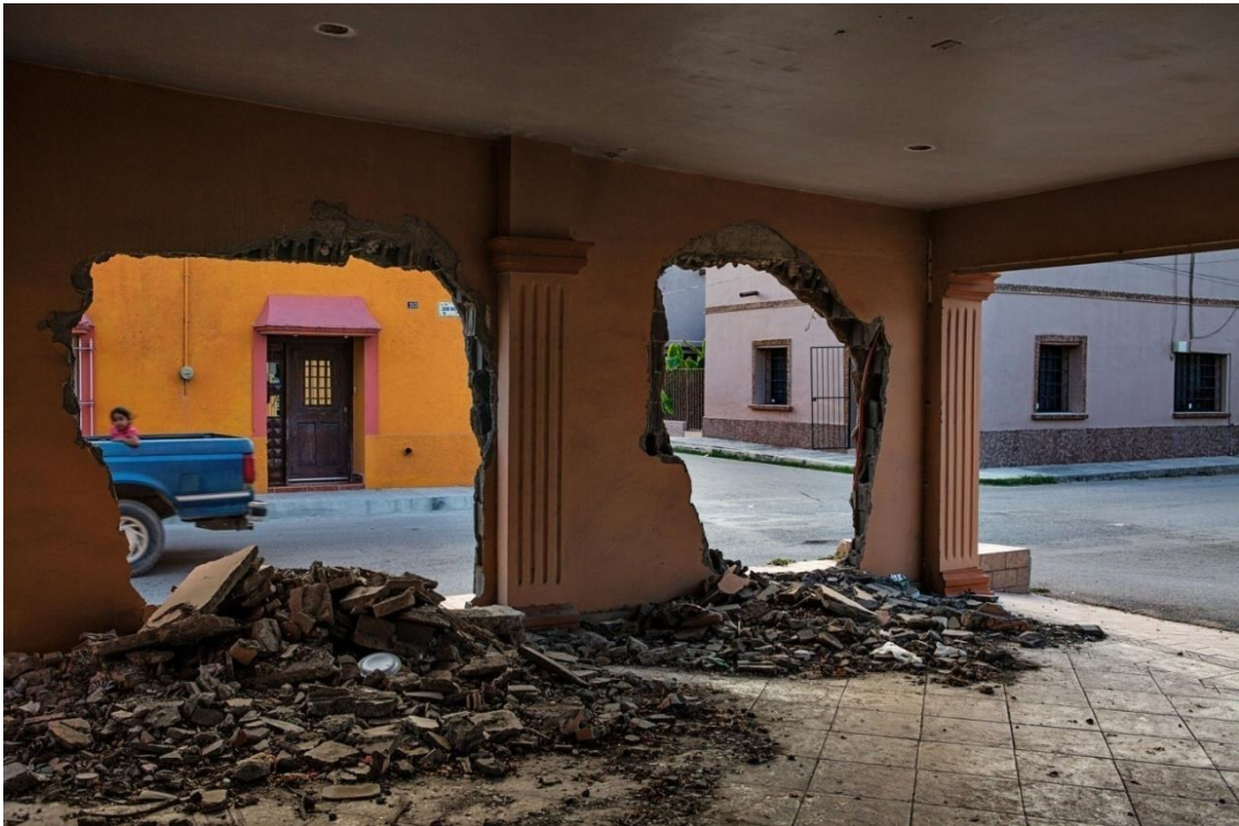
Casa destruida, frente al lugar donde vivía el alcalde de Allende. Foto: Kirsten Luce. Fuente: ProPublica. 273
