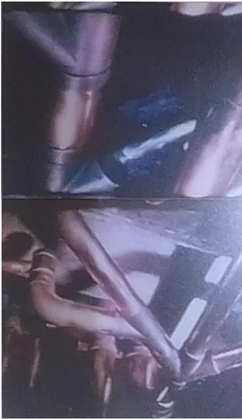
IMAGEN 108. TUBERÍA DE COBRE. (FOTOGRAFÍA PROPIA, 2019)
