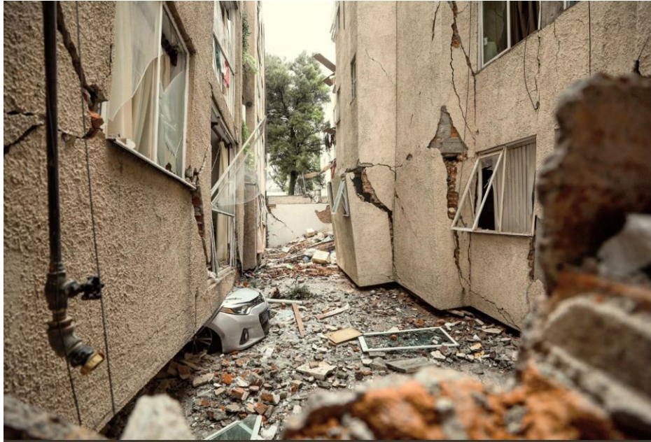
Figura 2.16 Edificio de “planta baja débil” colapsado durante sismo del 19 de septiembre de 2017.
