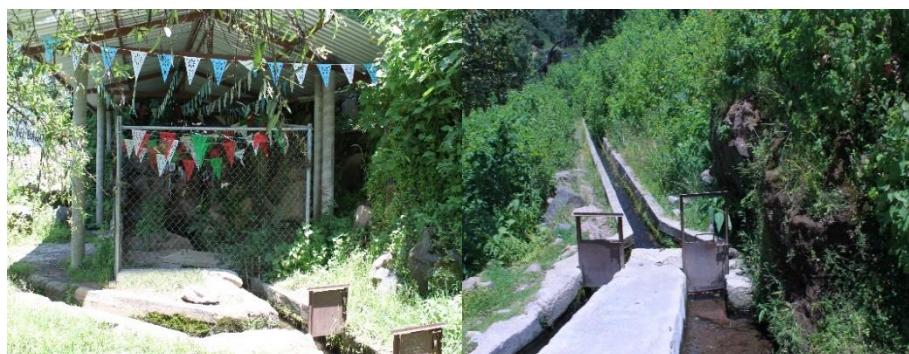
Figura 2.47 Vista del manantial protegido y canal que conduce el agua al pueblo de Tochimilco. (LCAyE, agosto, 2014)
