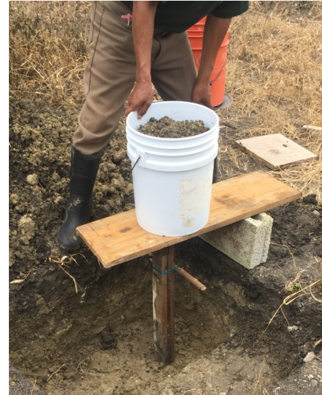
Imagen 30. Estudio de mecánica de suelo en sitio, prueba de polín. Elaboración propia.
