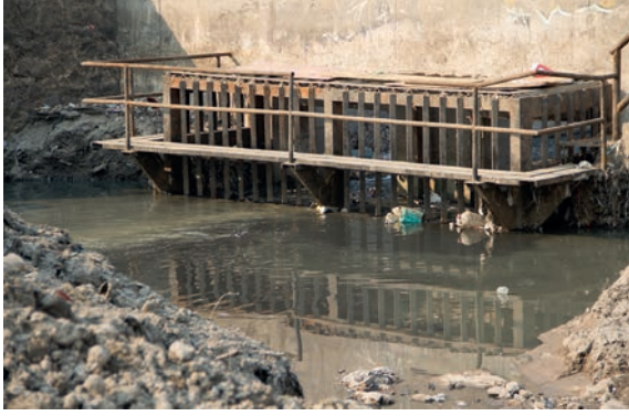
Barranca col. Los Pocitos Alcantarilla maestra
