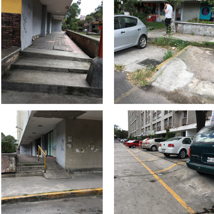
F.22 Fotografías por Fernanda Arenas mostrando los desniveles generados por el hundimiento.
