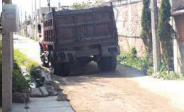
Descarga ilegal de cascajo en predios baldíos
