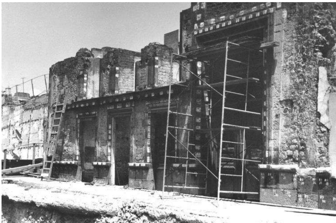
Demolición del edificio en Guatemala 50, Templo Mayor, exp, 32-21 al 32-24, año 1979. Foto: [CNA].
