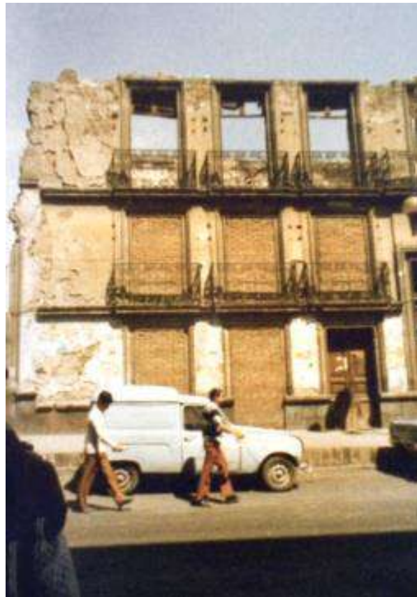
Fachada de la casa colonial en ruinas, suspensión y tapiado, Guatemala 50. Foto: [CNMH].
