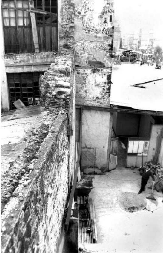
Pequeño patio generado a causa del desplome del muro medianero de la casa Seminario 6 a la izquierda. Foto: [CNMH].
