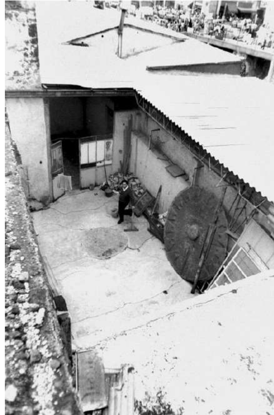
Vista del pequeño patio generado a causa de la destrucción del Taller de restauración del Museo Etnográfico por desplome. Foto: [CNMH].
