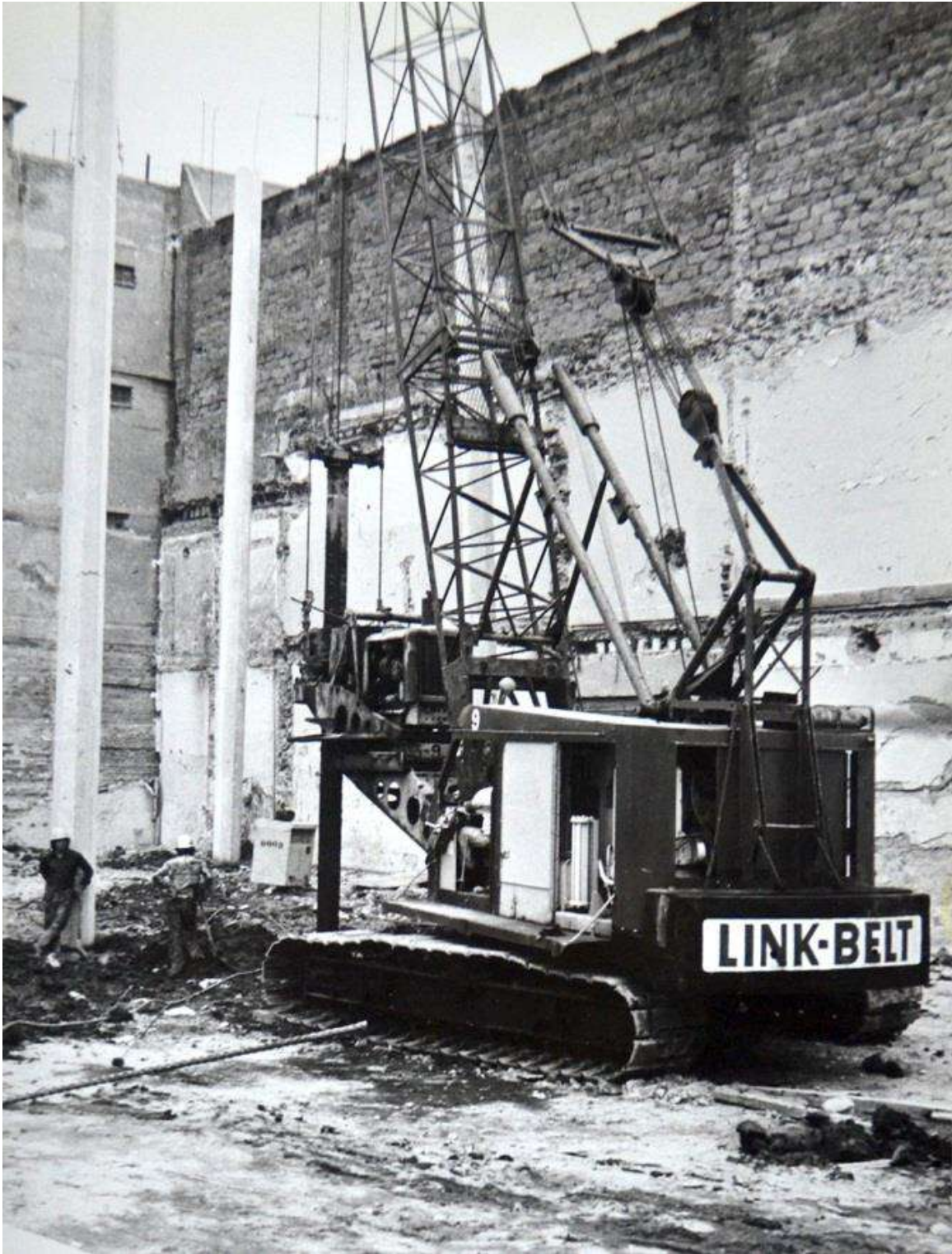
Construcción del Museo del Templo Mayor en uno de los tres predios para ello, Proceso de pilotaje en la zona del museo, Templo Mayor, exp, 32-39 al 32-41, año, 1982-1983, Foto: [CNA].
