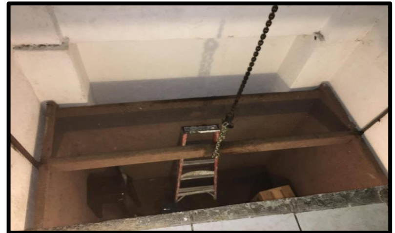
Montacargas ubicado en el primer nivel
