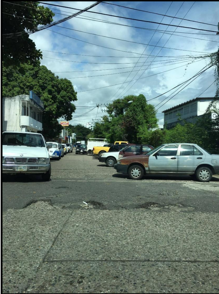
Entronque Avenida Sonora y Calle Miichoacan se aprecia claramente que el concreto hidraulico esta en mal estado
