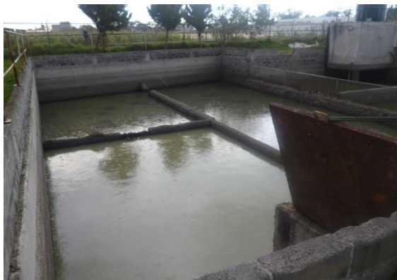
Figura 19. Cárcamo. Fuente: archivo propio [11 de octubre de 2019].
