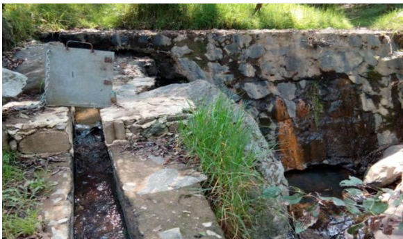
Figura 52. Una vez que el agua recorrió la presa, cae en el canal de conducción. Fuente: archivo propio [16 de noviembre de 2019].
