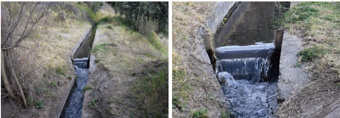
Figura 50. Presa rectangular que se dispuso para conocer el caudal exacto que utilizaba San Miguel Tlaixpan. Actualmente sirve para medir la cantidad de agua que trascurre cada que se renuevan los títulos de concesión. Se mide la longitud del coronamiento de la presa y se
